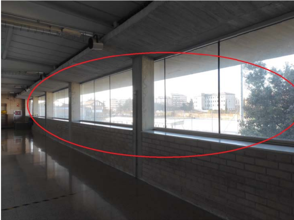
Pasillo de la grada, otro punto de deslumbramiento aunque dispone de un amplio alero.
