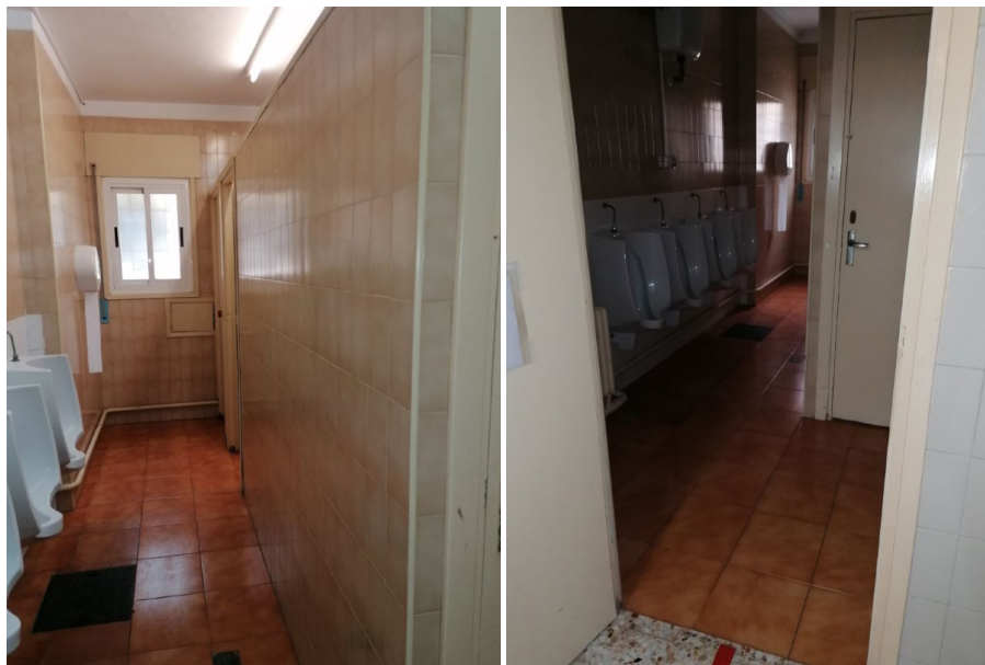
Aseo sin renovar para su adecuación como aseo accesible
