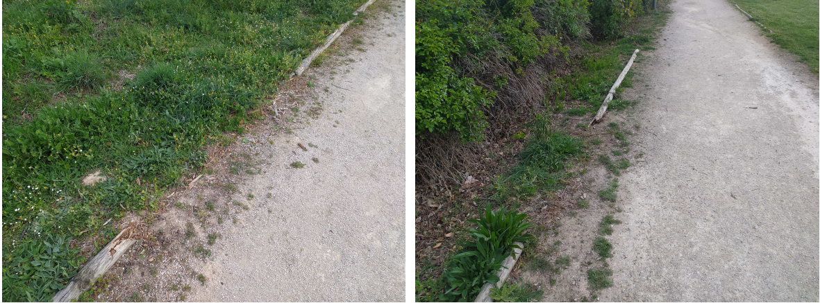
- Imágenes representativas del estado que presentan las piezas de madera -
