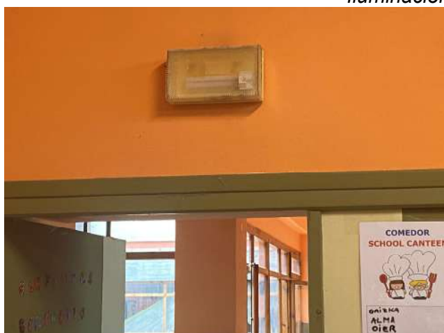
Emergencias aulas / pasillos
