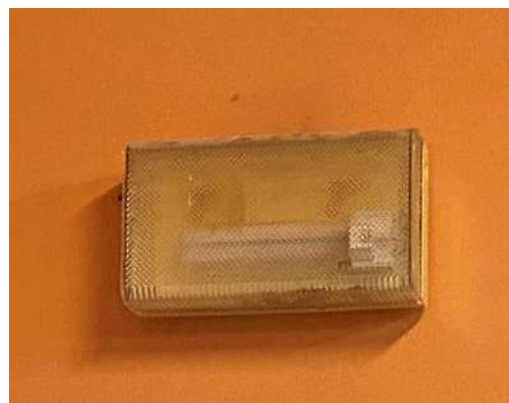
Luminarias existentes edificio
