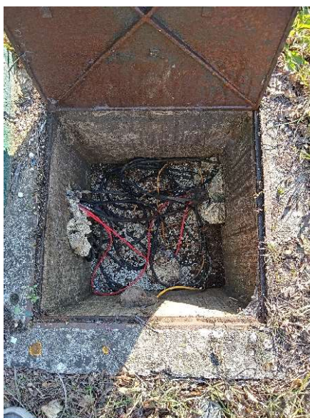
Imagen 9. Arqueta de la red de semaforización de intersección
