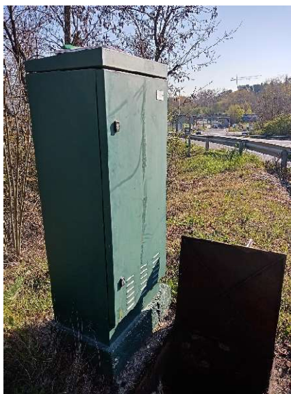
Imagen 8. Armario de control de semáforos
