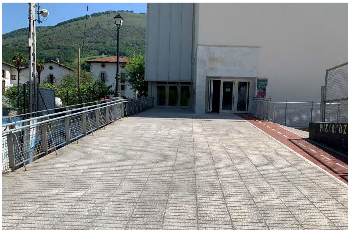
Imagen del acceso principal al centro. La rampa no reúne condiciones de accesibles: su pendiente es del 12 % y su longitud cercana a 15 m.
