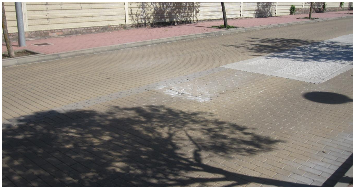
28.- Zona con pavimento de adoquines deteriorado en el final de la actuación
