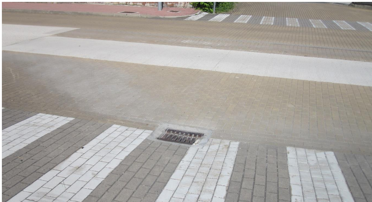
26.- Cruce de viales con sendos pasos de peatones a nivel. Como puede apreciarse, el drenaje sigue orientado hacia el lado izquierdo en el sentido del avance
