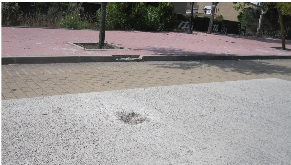
6.- Pavimento degradado, incluso después de la reparación y bordillo a sustituir en acera izquierda
