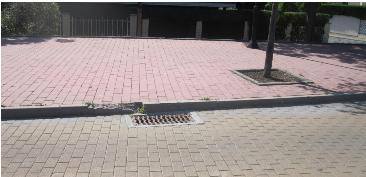
22.- Rejilla y bordillo deteriorado. El drenaje sigue hrientado hacia la zona más próxima al casco urbano
