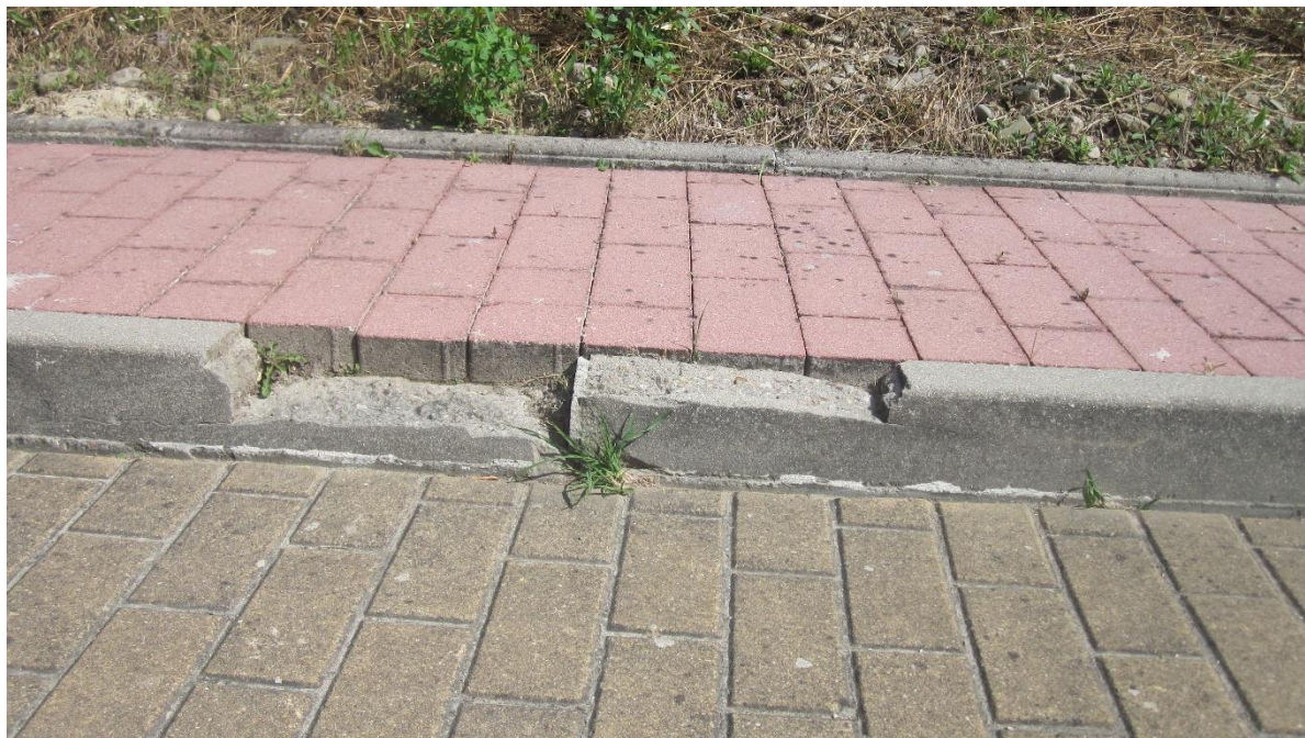
5.- Zona de bordillo a sustituir en la acera derecha en sentido del avance (Zona de aparcamiento)
