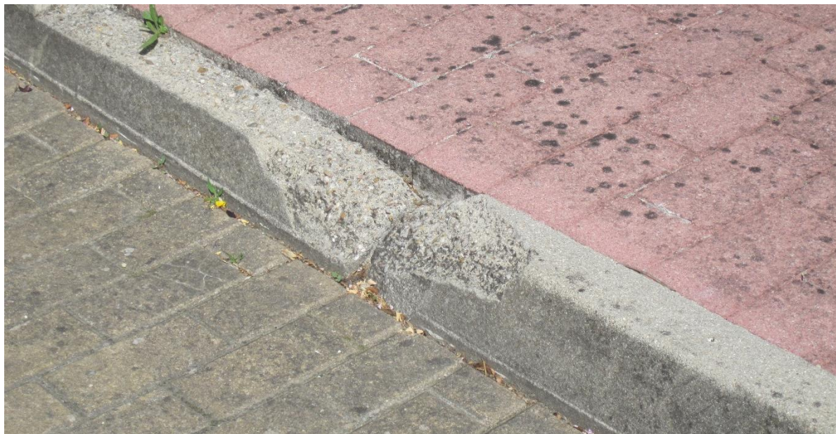
9.- Bordillo deteriorado a sustituir
