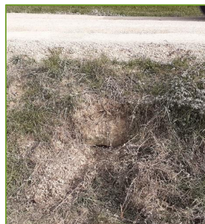
Detalle de paso de agua colmatado
