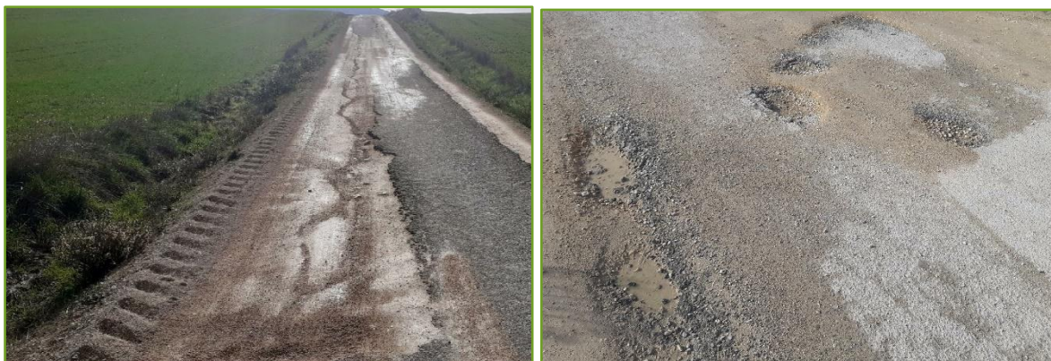
Tramos con defectos en la capa de rodadura
