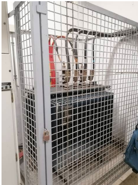
Transformador en planta sótano
