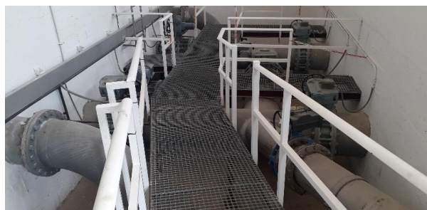
ETAP: Cámara de llaves salida
