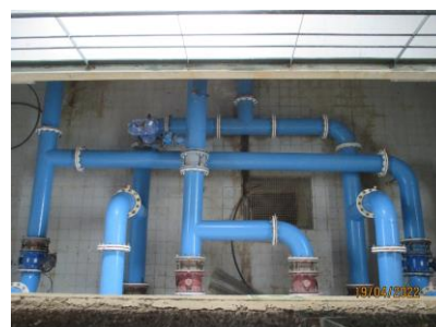
Depósito de Montes de Cierzo: Cámara de llaves
