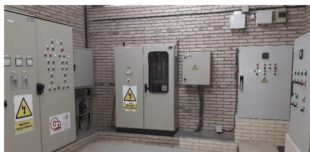
Bombeo de Montes de Cierzo: cuadros CCM
