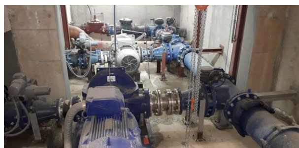
Bombeo de M. de Cierzo: Grupos de bombeo 3 y 4
