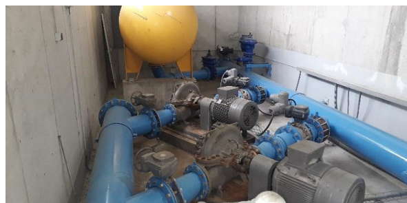
ETAP: Bombeo a Labradas
