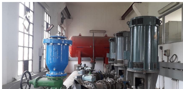
Bombeo del Ebro: Bombas 1, 2 y 3
