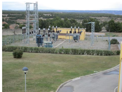
ETAP: Subestación eléctrica
