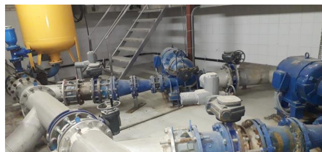
Bombeo de Montes de Cierzo: Grupo de bombeo 1+2
