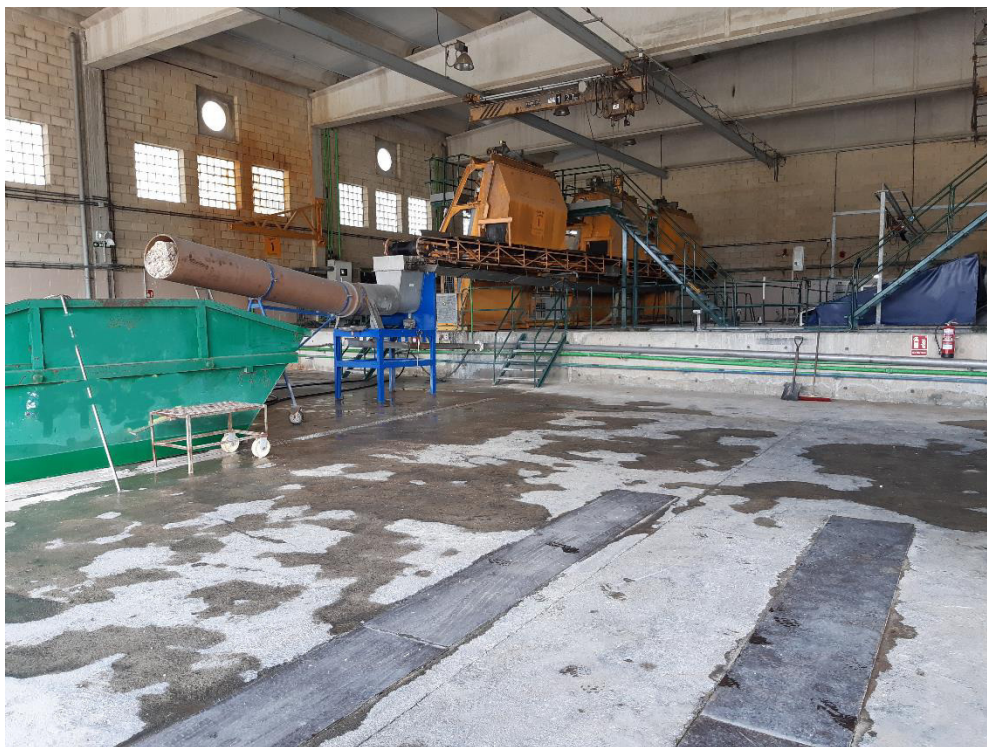
Vista del interior del edificio de pretratamiento en el cual se instalará el puente grúa. Al fondo las rejillas de desbaste de gruesos situadas sobre los canales de entrada de aguas residuales.
