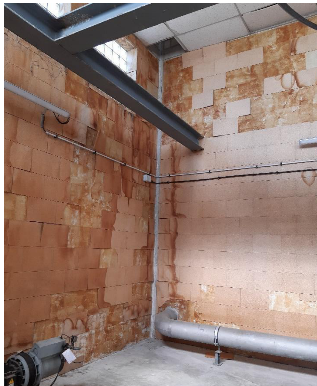
Vista de la sala de soplantes Al fondo y en la esquina, el pilar medianil con la sala de rejás.
