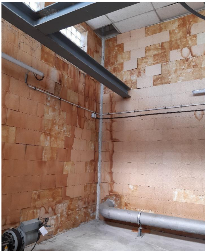
Vista de la sala de soplaes Al fondo y en la esquina, el pilar medianil con la sala de rejillas.
