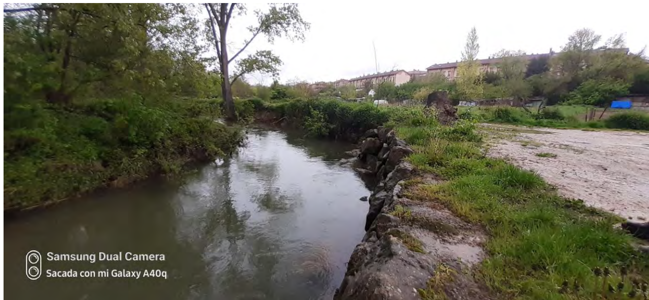
Talud descarnado en tramo curvo.
