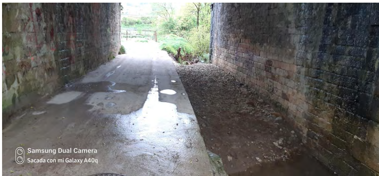
Depósito de materiales al lado del camino, que taponan el paso del río.
