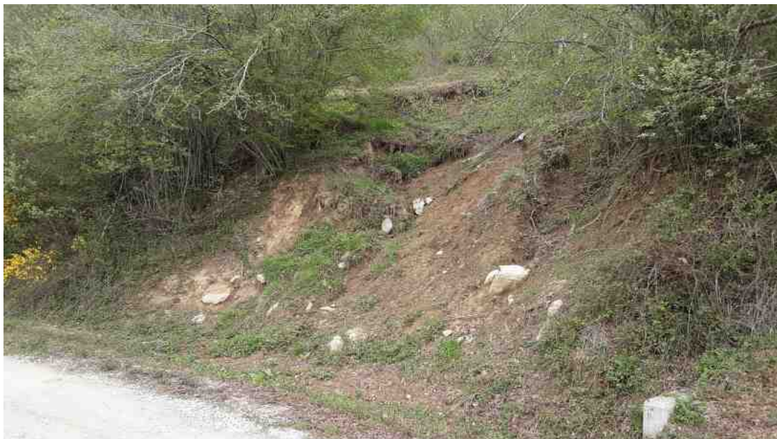
Figura 15: Desprendimiento de tierras
