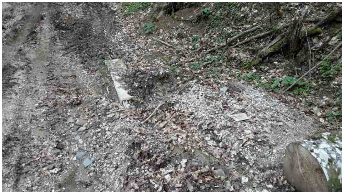
Figura 19: Drenaje transversal aterrado
