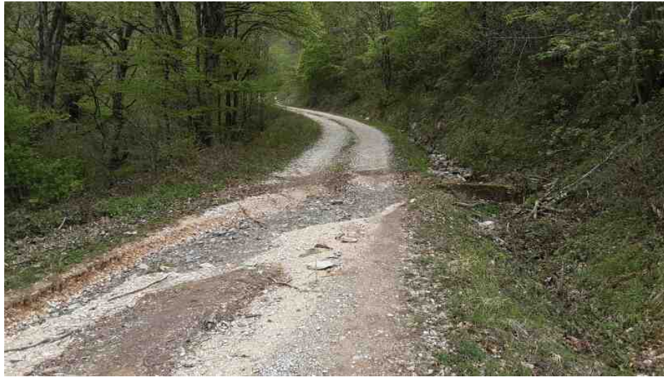
Figura 9: Zona inicio afección
