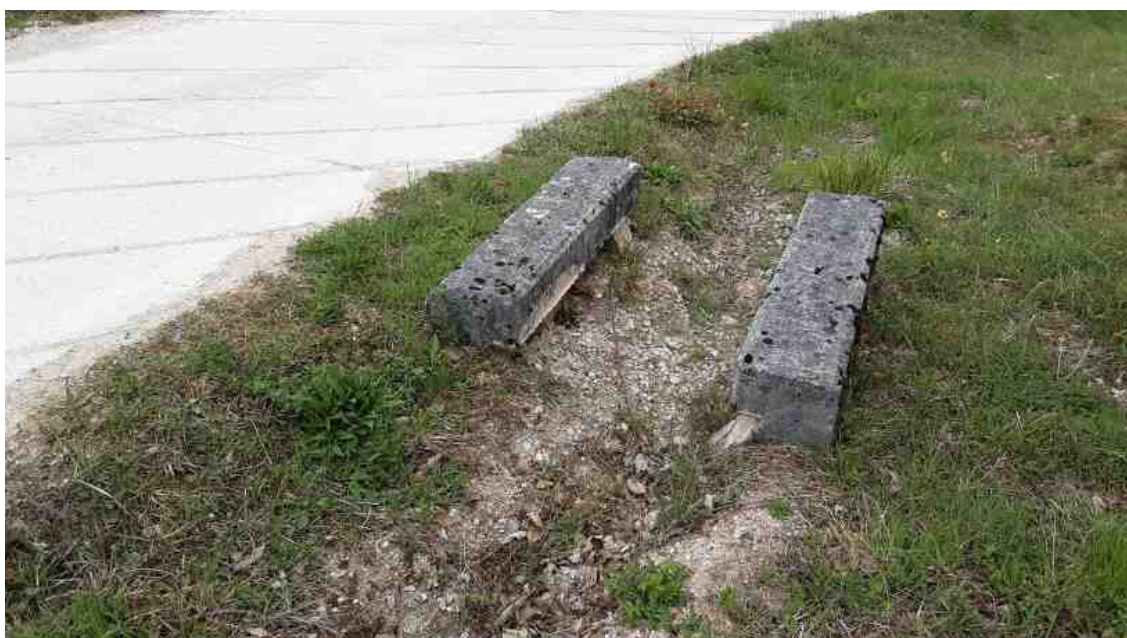
Figura 16: Drenaje transversal taponado
