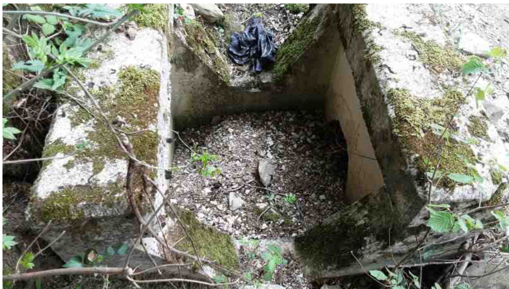
Figura 14: Drenaje transversal atascado
