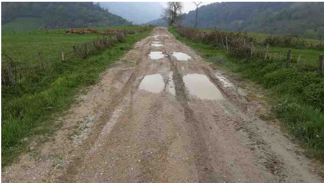
Figura 18: Socavones en el firme
