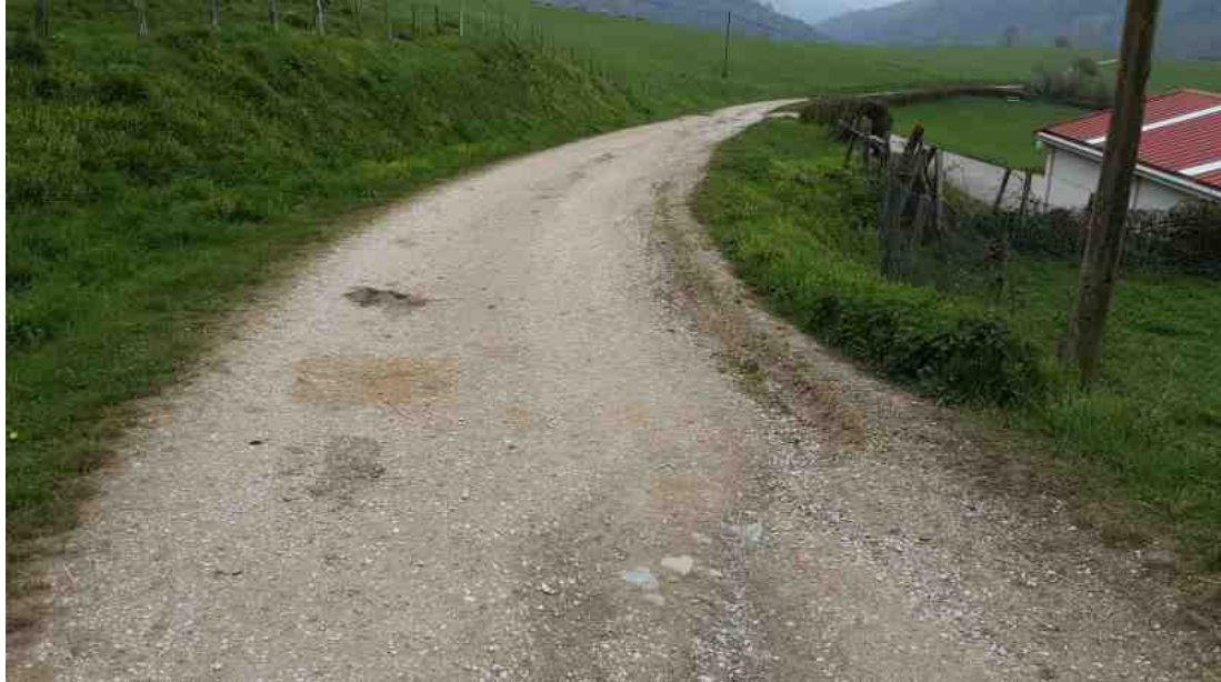
Figura 17: Surcos en el pavimento
