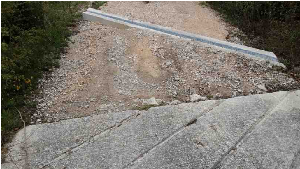
Figura 22: Bionda de drenaje
