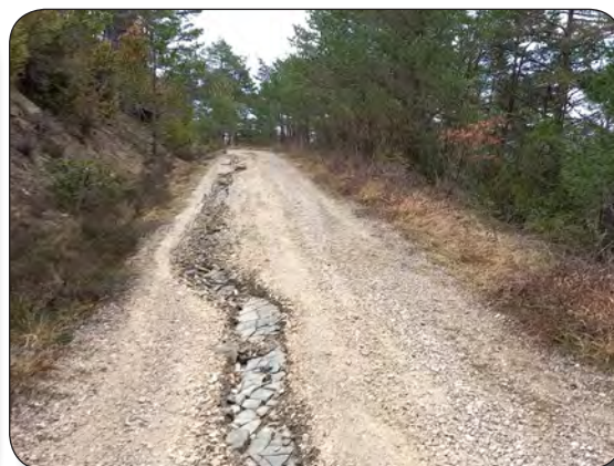
Daños en pista de Meazkoitz. Firme arrastrado
