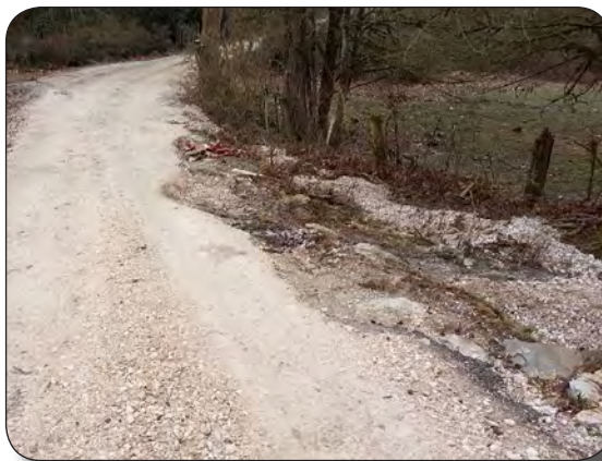
Tramo con firme más degradado, junto al puente
