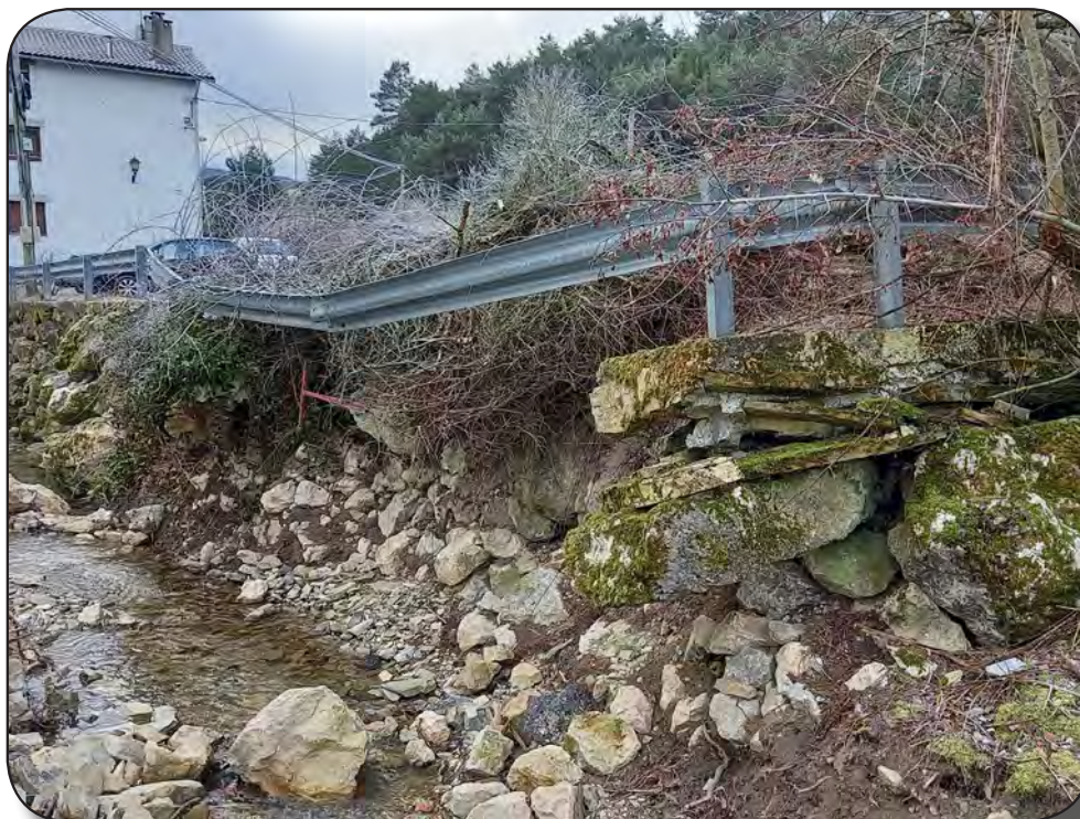
Vista de la escollera tras las riadas Se aprecia el tramo con piedras arrancadas (Las ramas que se ven en la foto corresponden a restos de poda amontonados en este punto)
