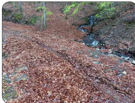
Tramo de pista deteriorado por escorrentía
