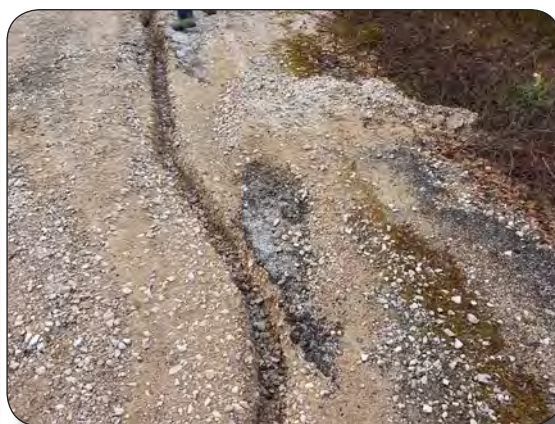
Daños en pista de Loizu a urniza
