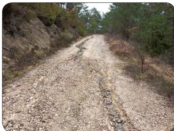
Daños en pista de Meazkoitz. Firme arrastrado
