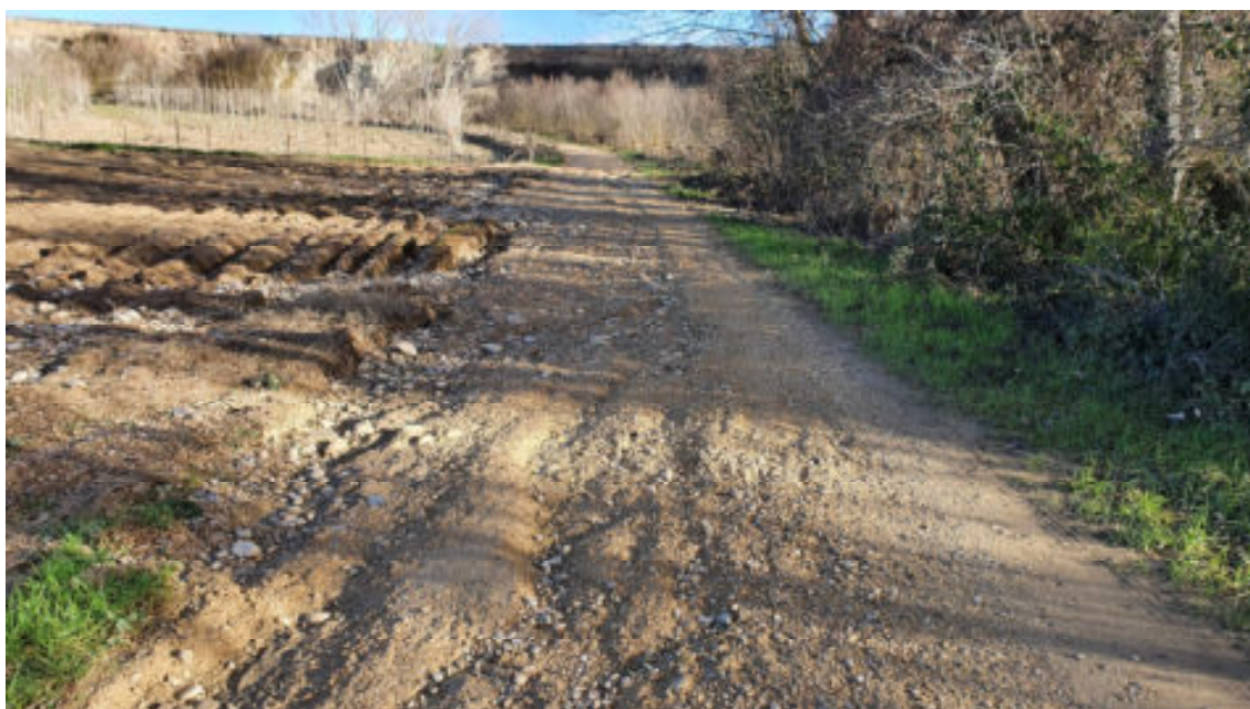
Camino San Martín. Daños en el firme del camino y evidentes daños en la finca adyacente.
