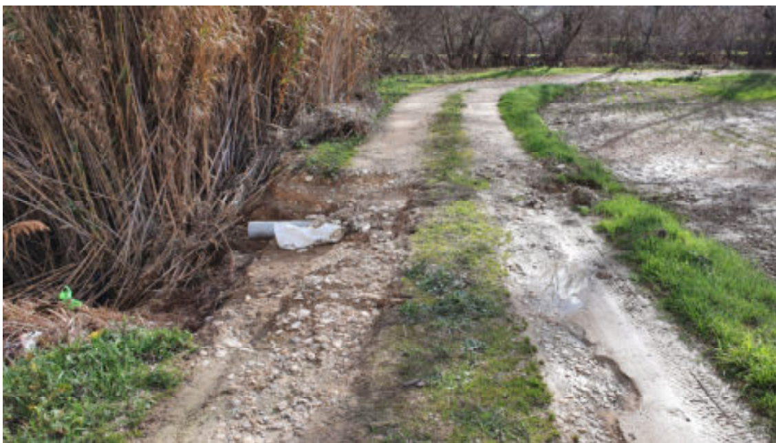
Camino donde la riada ha erosionado el terraplén y el propio camino
