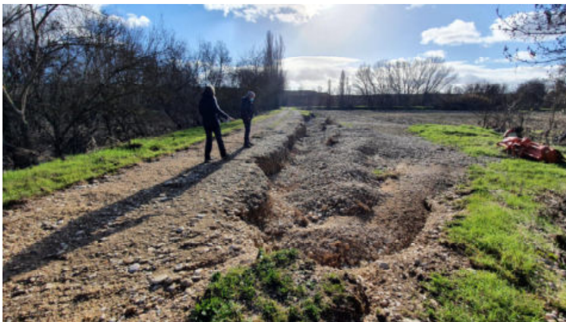
Camino donde la riada ha erosionado el terraplén
