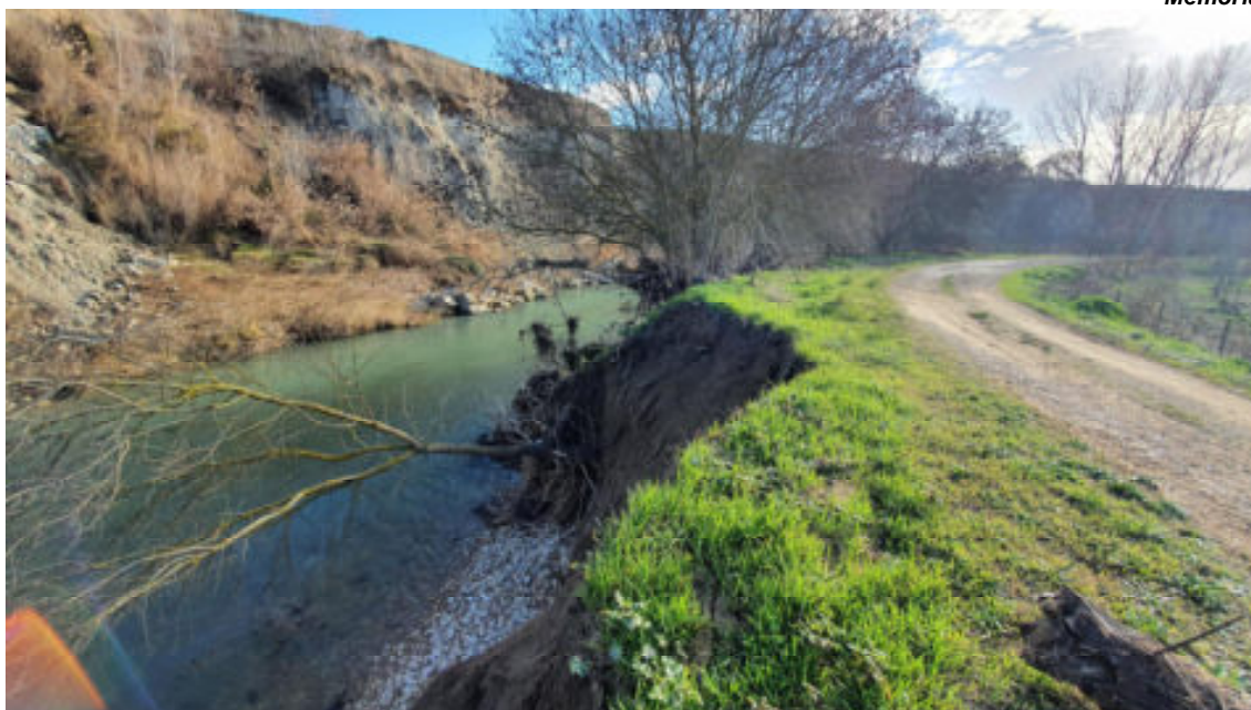
Camino San Martín2. Talud del camino dañado junto al río Ega
