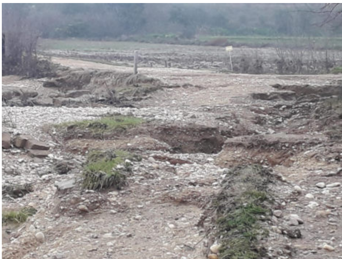
Camino Pieza La Parda1 totalmente dañado y que esta reparando en la siguiente imagen
