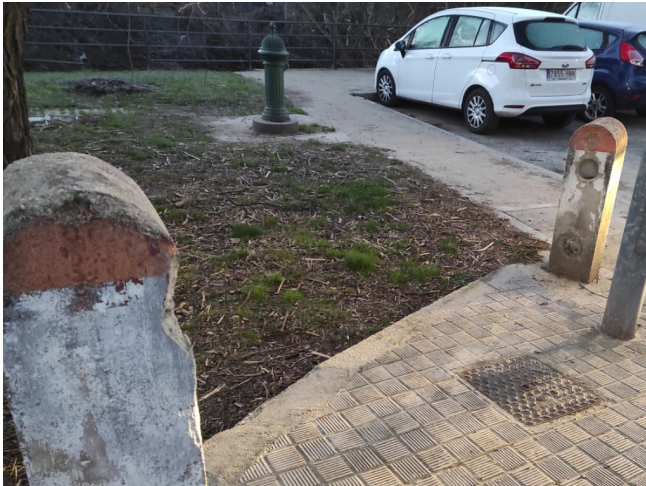
Imagen de la barandilla de piedra sin las barras transversales consecuencia de la riada
