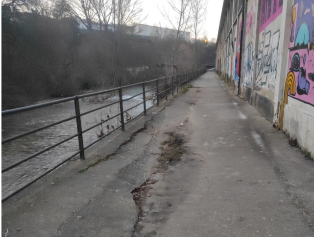
Imagen del camino de hormigón hundido a consecuencia de la riada
