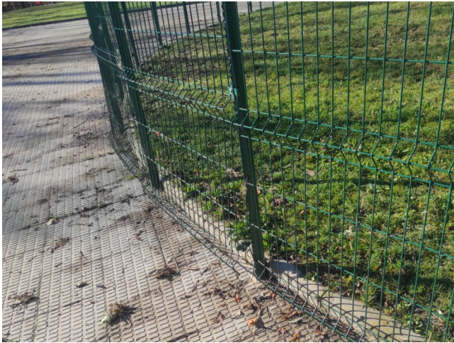
Imagen de la valla que delimita el ZECAN forzada debido a la riada
