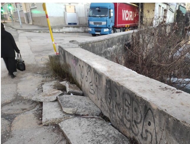
Imagen del cubre muros de hormigón en el suelo debido a la riada
