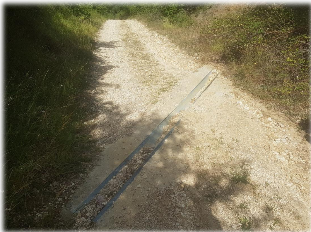
Fotografía 5: Bionda a quitar y cambiar por la construcción de drenajes en forma de Badén natural
