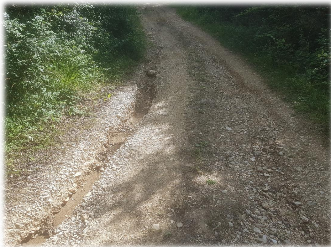
Fotografía 3: Comienzo del Tramo 2, material suelto y grandes roderas por la escorrentía
