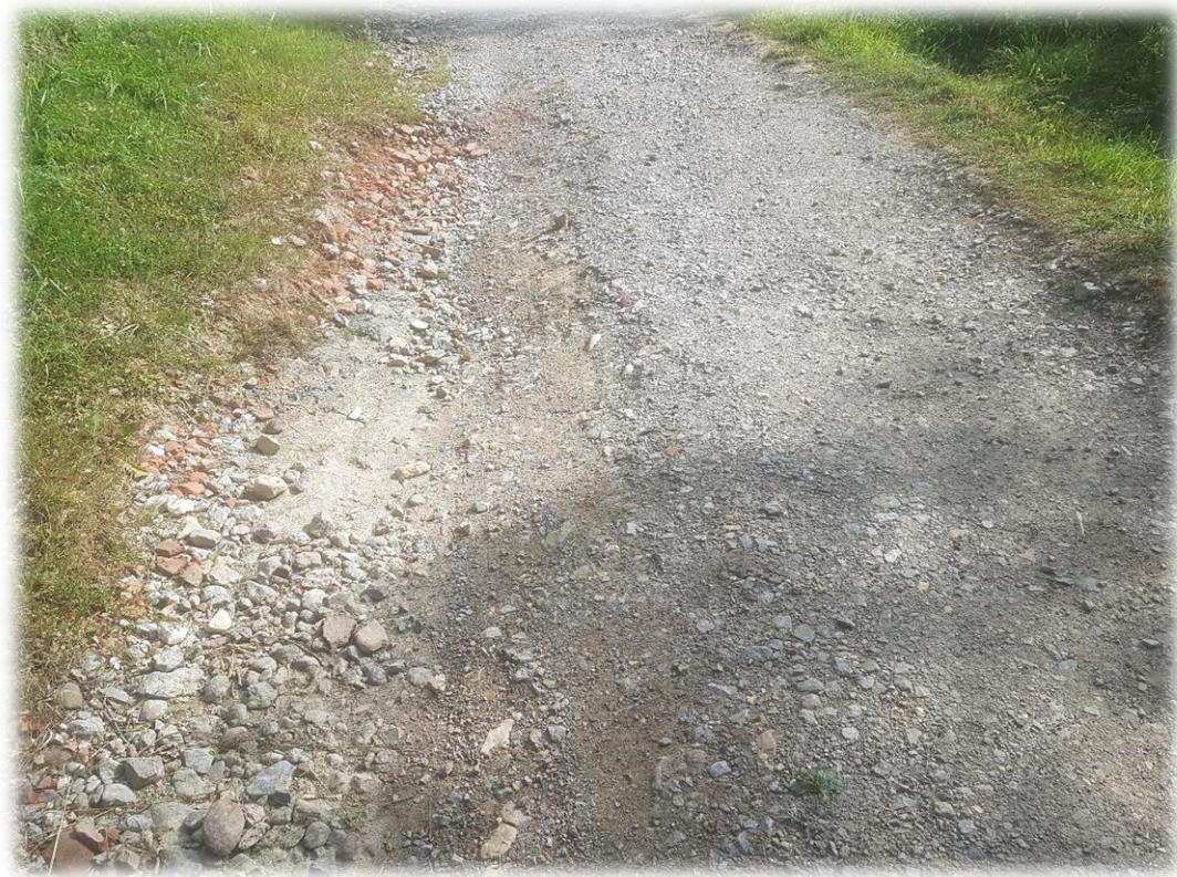
Fotografía 2: Vista general del camino lavado y en mal estado.
