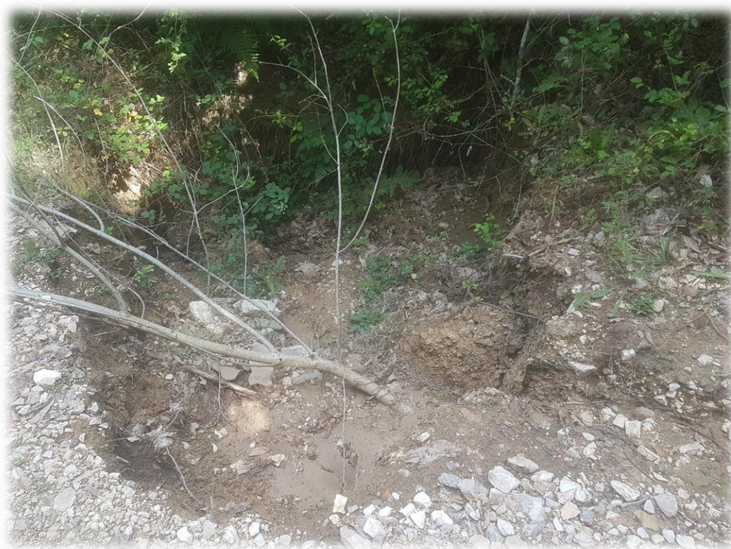
Fotografía 8: Zona de desprendimiento de camino a reponer.
