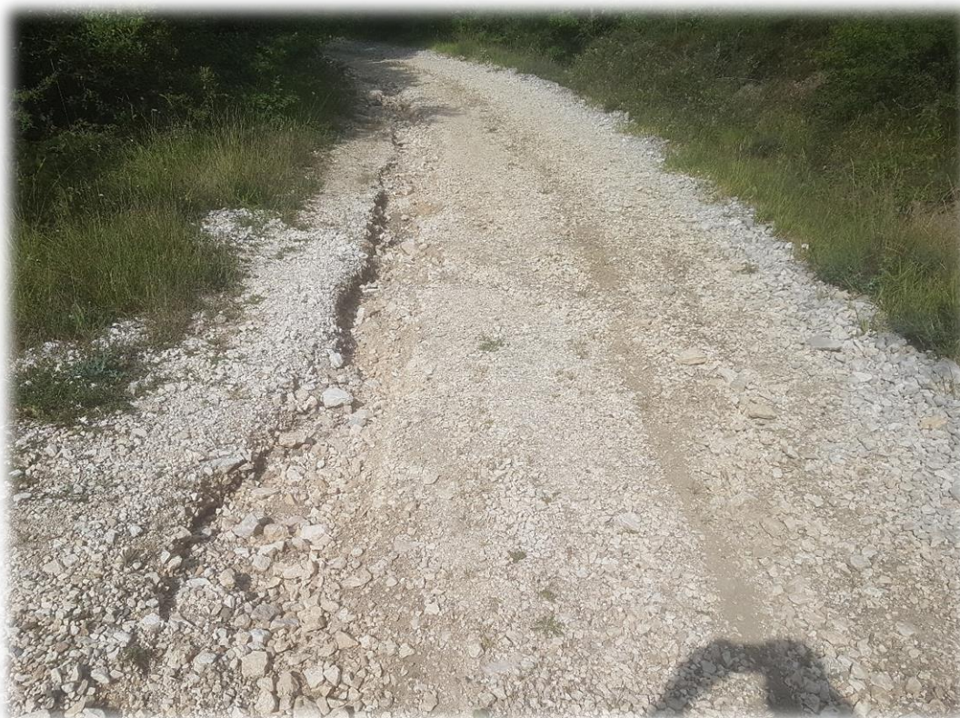
Fotografía 4: Vista general de las roderas en el camino por la escorrentía, material suelto.
