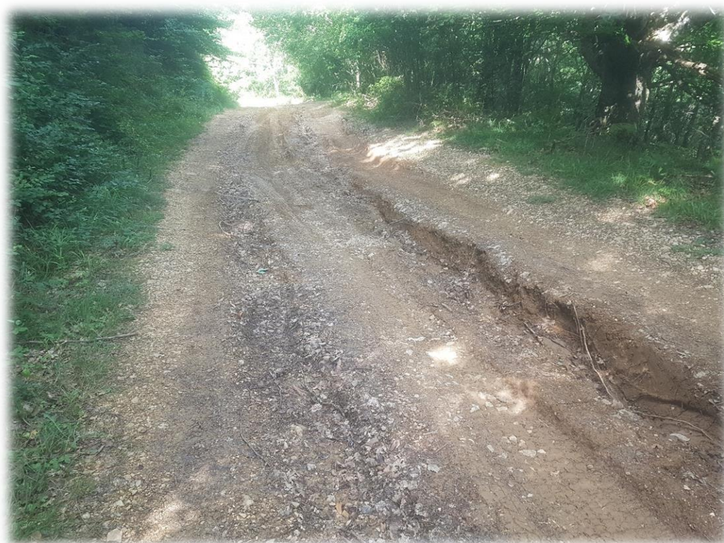
Fotografía 7: Grandes roderas producidas por el agua de escorrentía.
