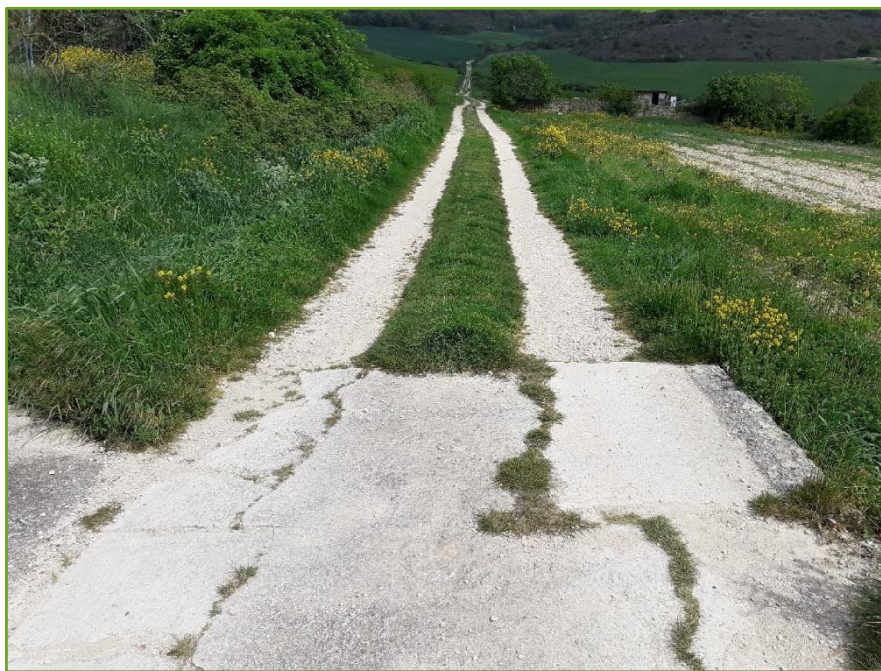
Detalle de cordones laterales y central, y de cuneta invadidas de vegetación
