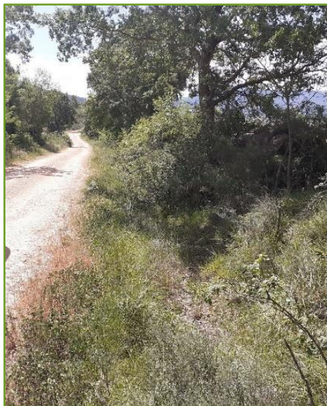
Detalle de estado actual de cunetas.
