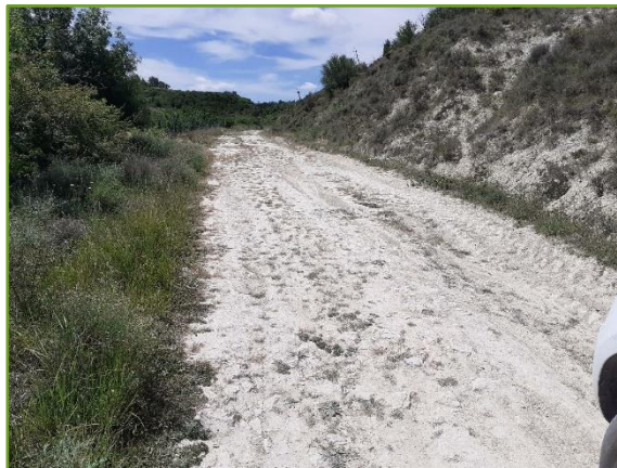
Detalle de irregularidades en explanada
