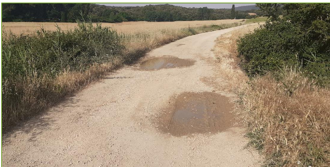
Zona bacheada sobre el puente de Cuatrolosas
