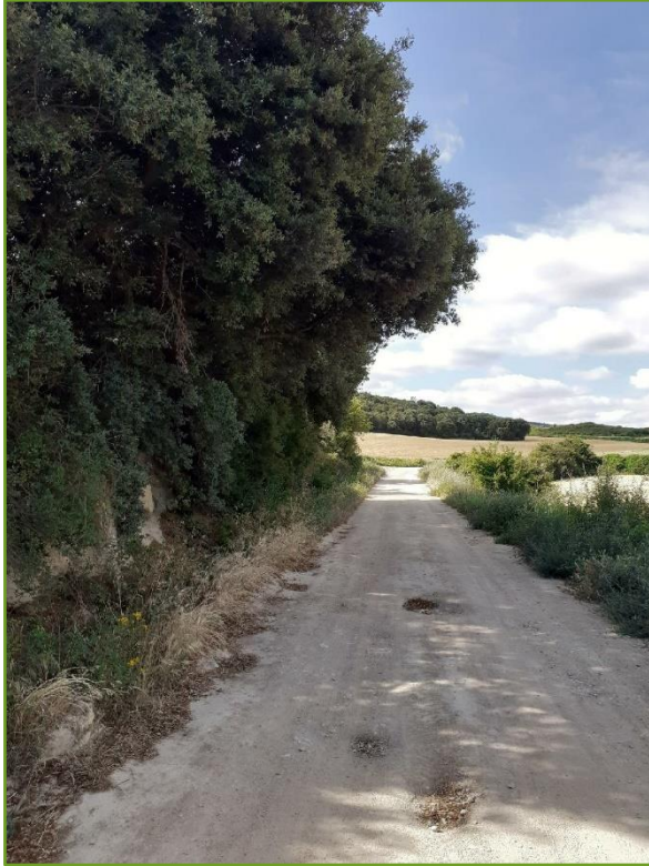
Tramo con baches y vegetación en bordes y cunetas en el camino del Robledo
