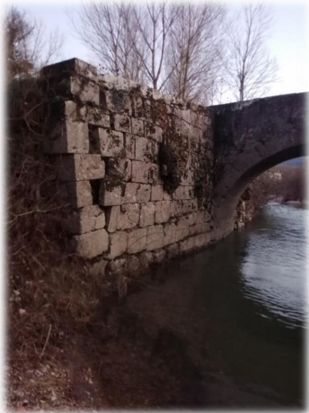
Fotografía 4: Vista del estribo desplazado desde el cauce, sito aguas abajo, margen derecha.
