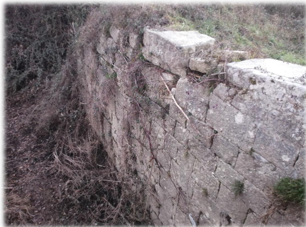
Fotografía 2: Vista general del estribo con piedras movidas y abombado, estribo de aguas arriba, margen izquierda
