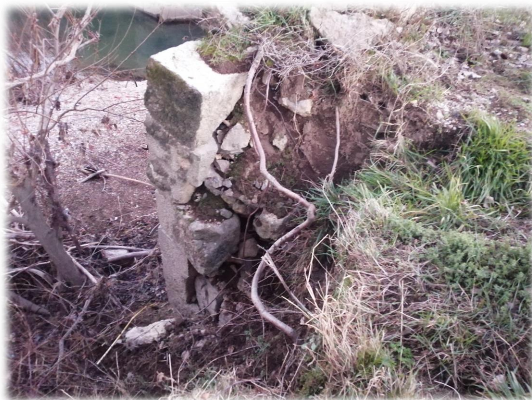
Fotografía 1: Vista del trasdós lavado y piedras movidas, estribo de aguas abajo, margen izquierda
