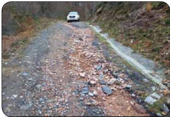
Usategieta-Landagaita. Arrastres por escorrentía
