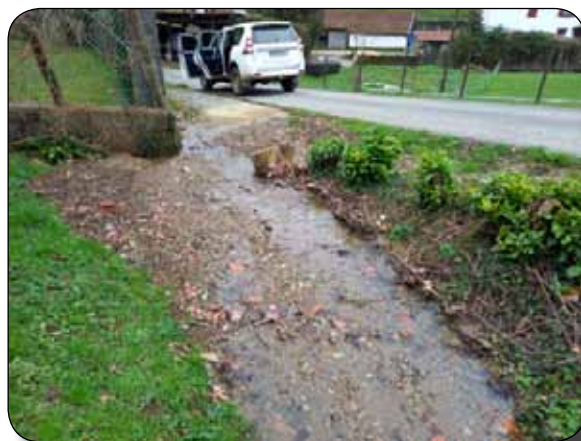
Xantelerreka 2, boca de aguas arriba colmatada
