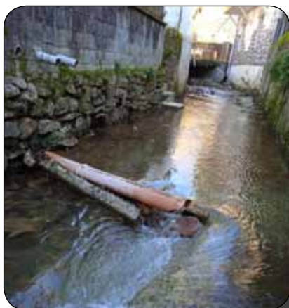
Xantelerreka 3. Conducción dañada
