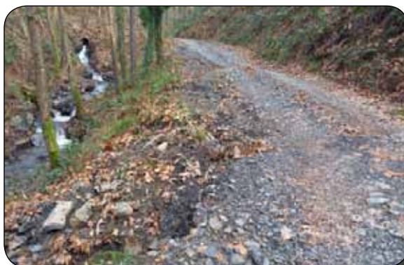
Sarralla. Derrame del terraplén
