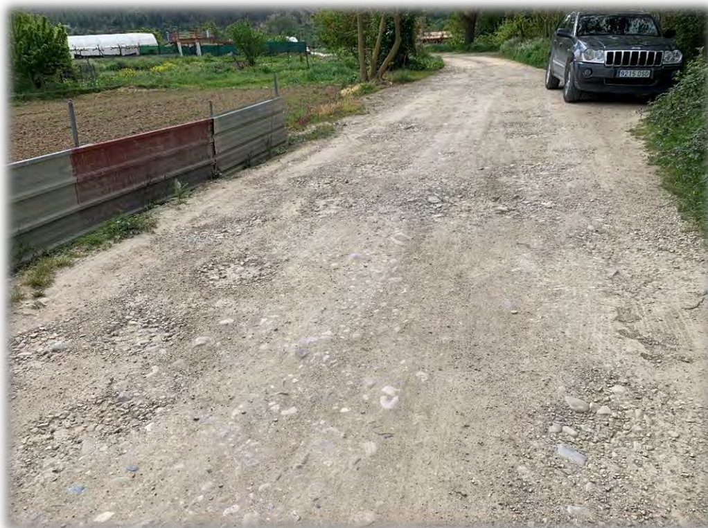
Fotografía 4: Vista general del camino, con subbase a la vista y formación de baches, debido a la pérdida de la rodadura por la erosión de la inundación
