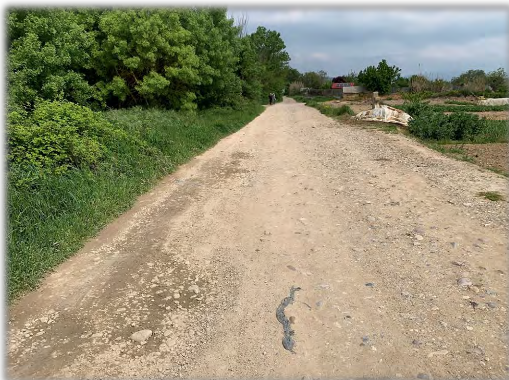
Fotografía 5: Vista general del camino, con subbase a la vista y formación de baches, debido a la pérdida de la rodadura por la erosión de la inundación
