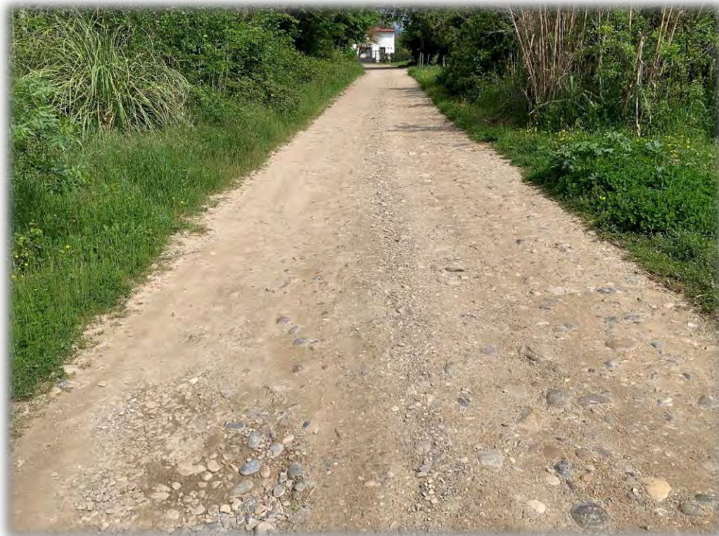
Fotografía 6: Vista general del camino, con subbase a la vista y formación de baches, debido a la pérdida de la rodadura por la erosión de la inundación
