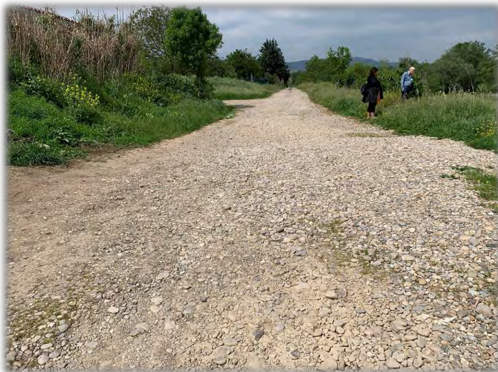
Fotografía 8: Vista general del camino, con acumulación de cantos rodados arrastrados y depositados por el agua
