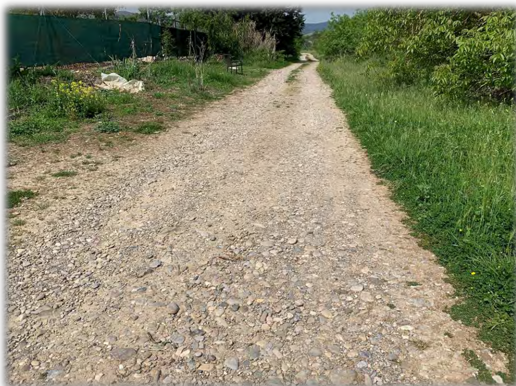
Fotografía 7: Vista general del camino, con subbase a la vista y formación de baches, debido a la pérdida de la rodadura por la erosión de la inundación
