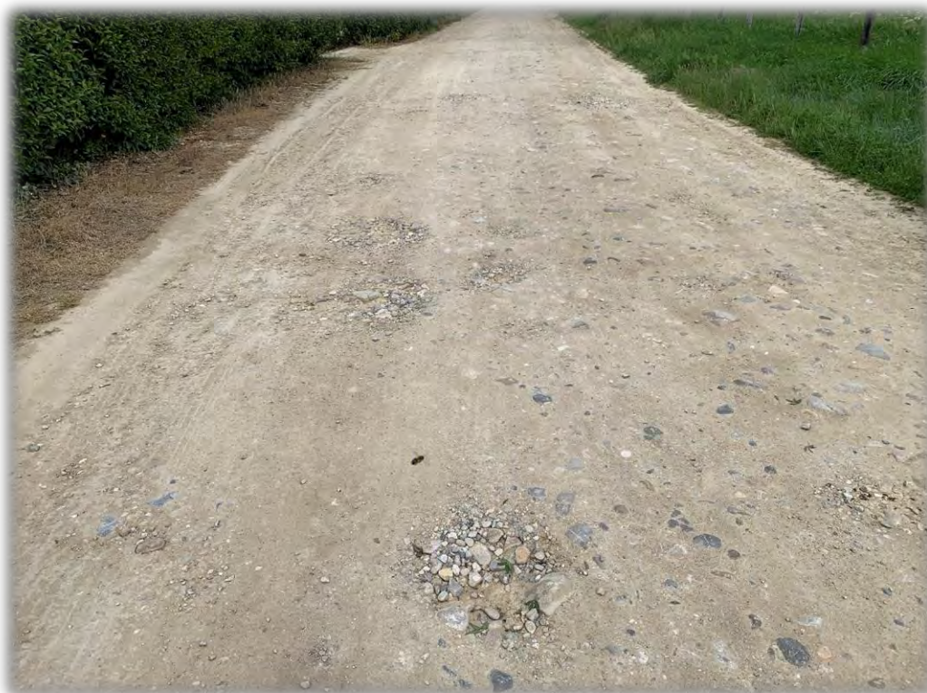
Fotografía 2: Vista general del camino, con subbase a la vista y formación de baches, debido a la pérdida de la rodadura por la erosión de la inundación
