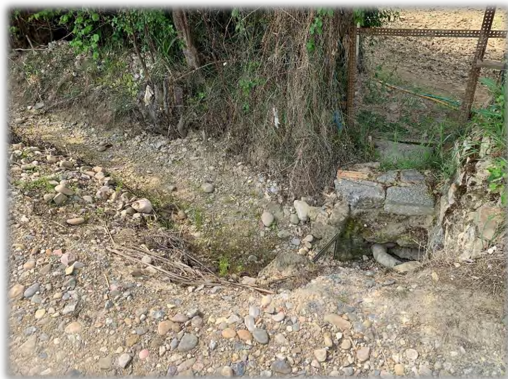
Fotografía 8: Vista de la aleta de obra de fábrica derruida y que se debe reparar al estar afectando a la estabilidad de la plataforma del camino
