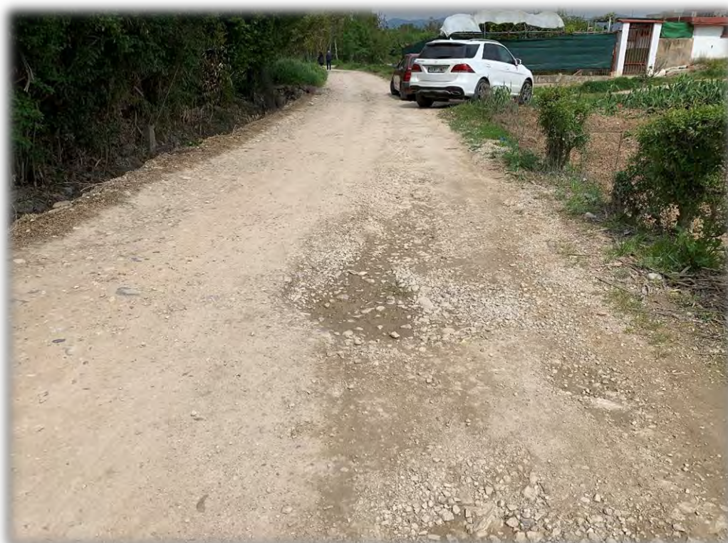
Fotografía 3: Vista general del camino, con subbase a la vista y formación de baches, debido a la pérdida de la rodadura por la erosión de la inundación
