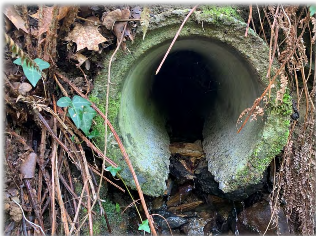
Fotografía 19: Obra de fábrica dañada, con fisura longitudinal en su generatriz inferior en toda su longitud.
