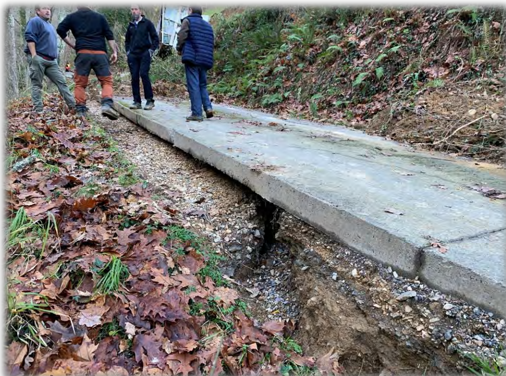
Fotografía 8: El deslizamiento de la ladera provocó que el firme de hormigón quedará separado unos 70 cm de su berma y suspendido unos 10 cm. También, se observa la vía de escape que erosiona el agua subterránea bajo el camino.
