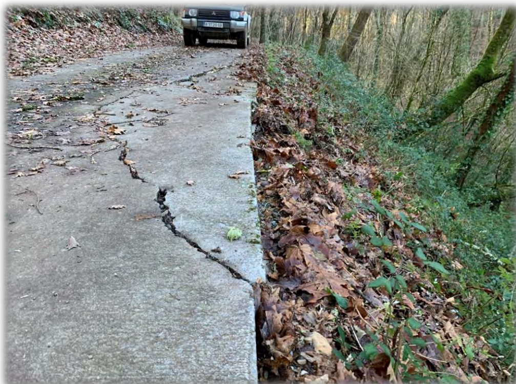
Fotografía 20: Deslizamiento del talud de sujeción que ha provocado el daño estructural del firme del camino y que requiere repararse.
