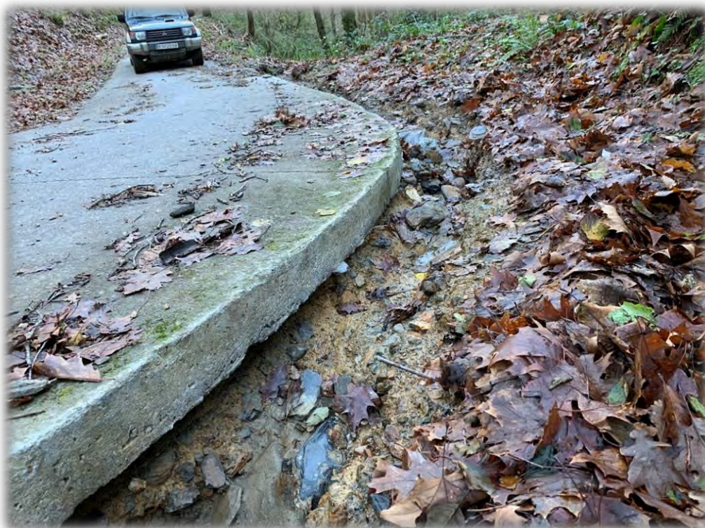
Fotografía 17: Ligero descalce del camino por erosión del agua que fue incapaz de desaguar la obra de fábrica que hay detrás del punto de toma..
