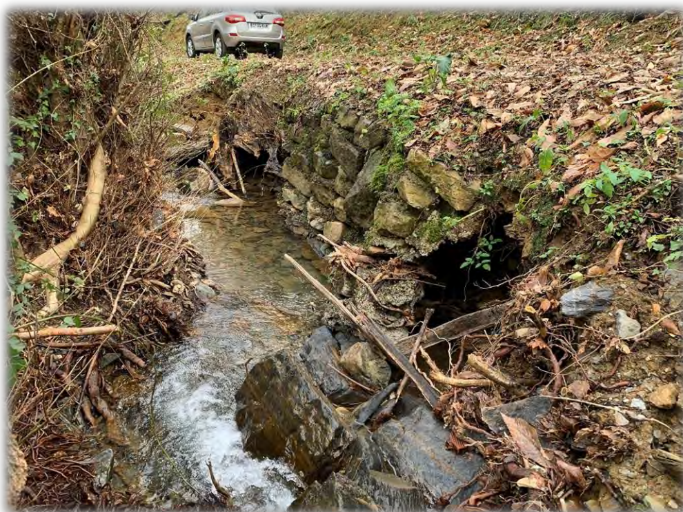
Fotografía 23: Erosión de la margen derecha de la regata y que afecta a la estabilidad del camino. Se observa como un muro de contención y protección del camino ha quedado dañado por lavado de su trasdós y zapata.
