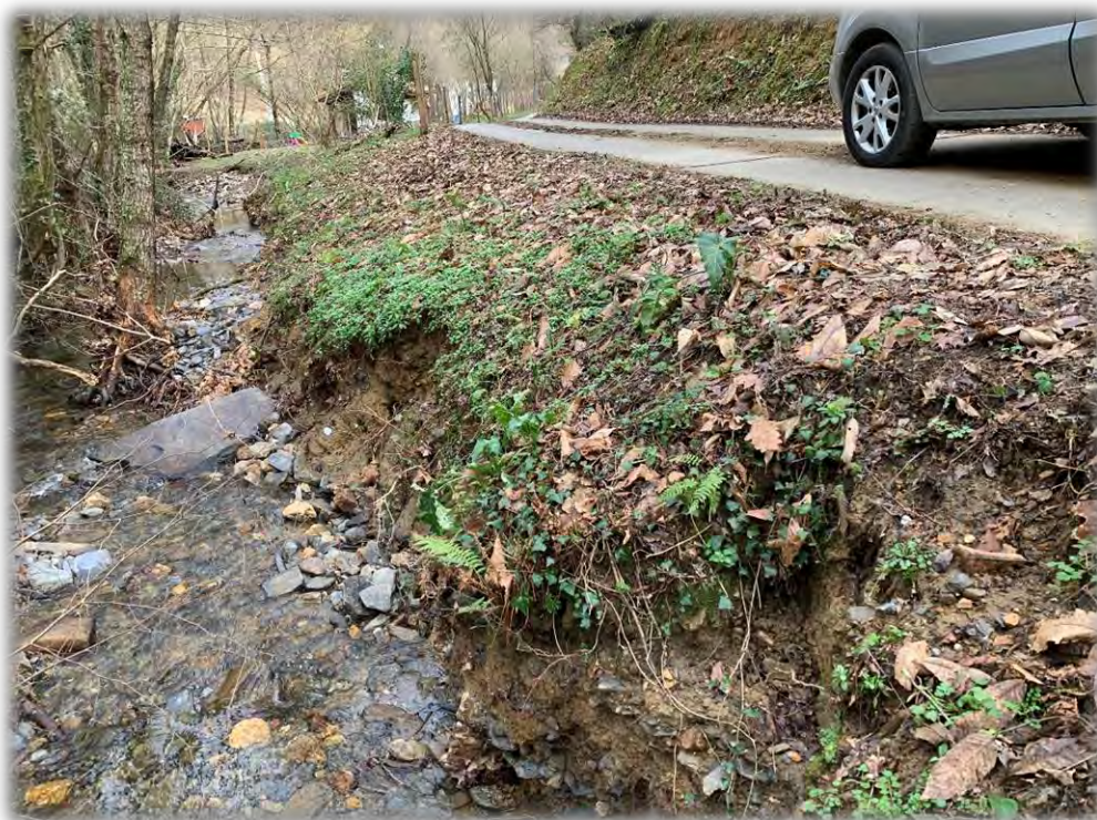
Fotografía 25: Erosión de la margen derecha de la regata y que afecta a la estabilidad del camino.
