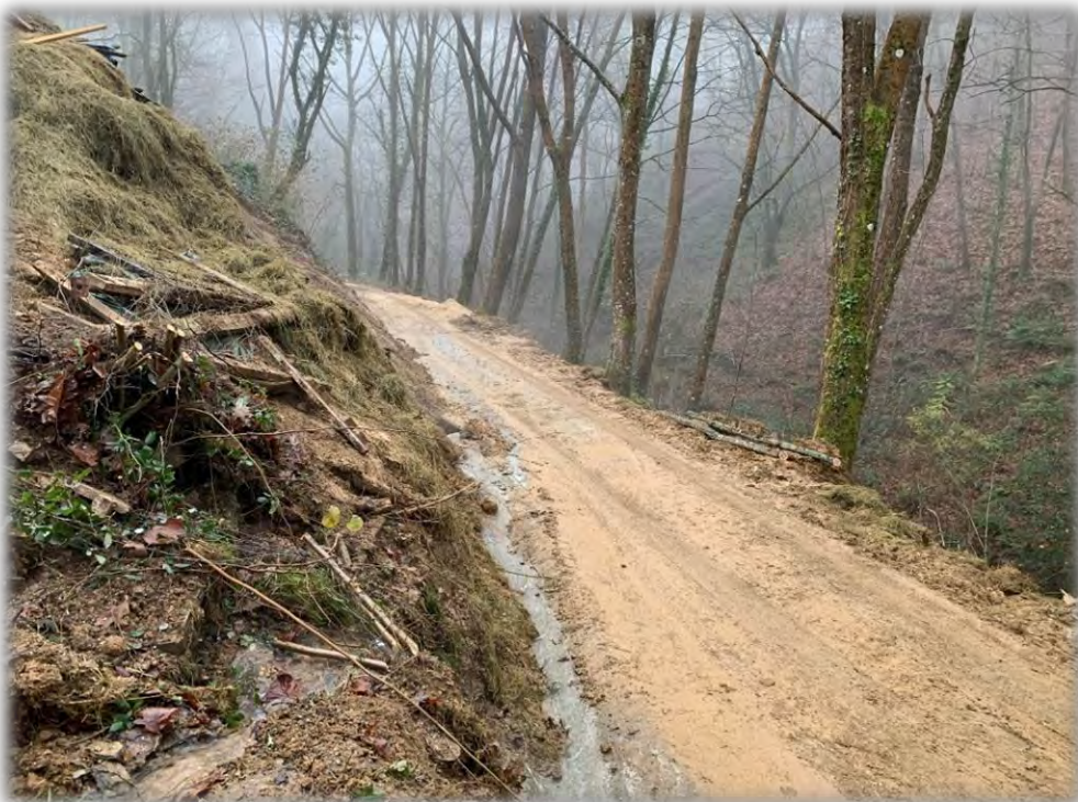
Fotografía 1: Material del deslizamiento sobre el camino.
