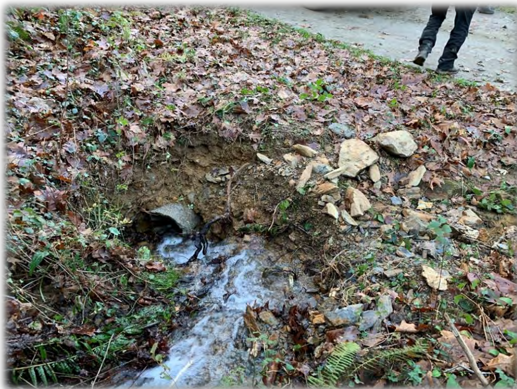
Fotografía 13: Embocadura de obra de fábrica dañada, y de diámetro interior 300 mm que es insuficiente.
