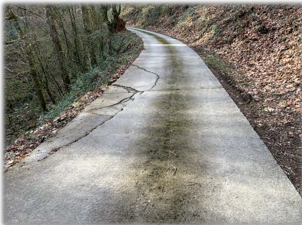
Fotografía 21: Deslizamiento del talud de sujeción que ha provocado el daño estructural del firme del camino y que requiere repararse mediante retranque del vial hacia el desmonte.
