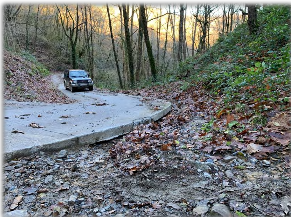
Fotografía 16: Ligero descalce del camino por erosión del agua que fue incapaz de desaguar la obra de fábrica que hay detrás del punto de toma.
