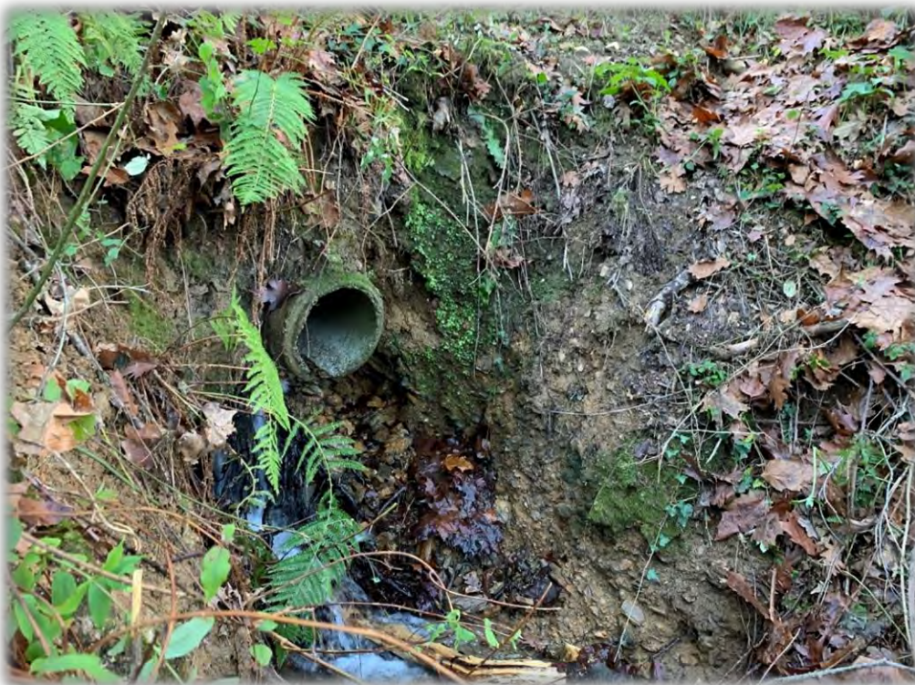
Fotografía 14: Obra de fábrica dañada, el agua sale por el terreno no por el caño, ya que está dañado antes de su desembocadura al abrirse sus juntas, minando el vial.
