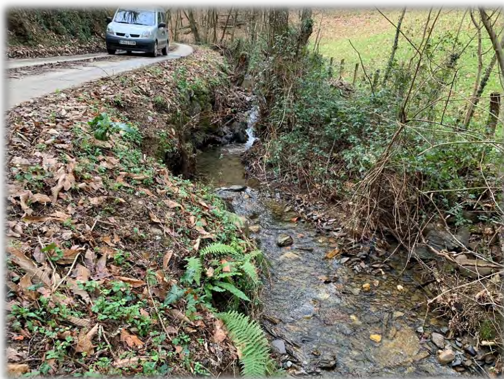
Fotografía 24: Erosión de la margen derecha de la regata y que afecta a la estabilidad del camino. Se observa como un muro de contención y protección del camino ha quedado dañado por lavado de su trasdós y zapata.
