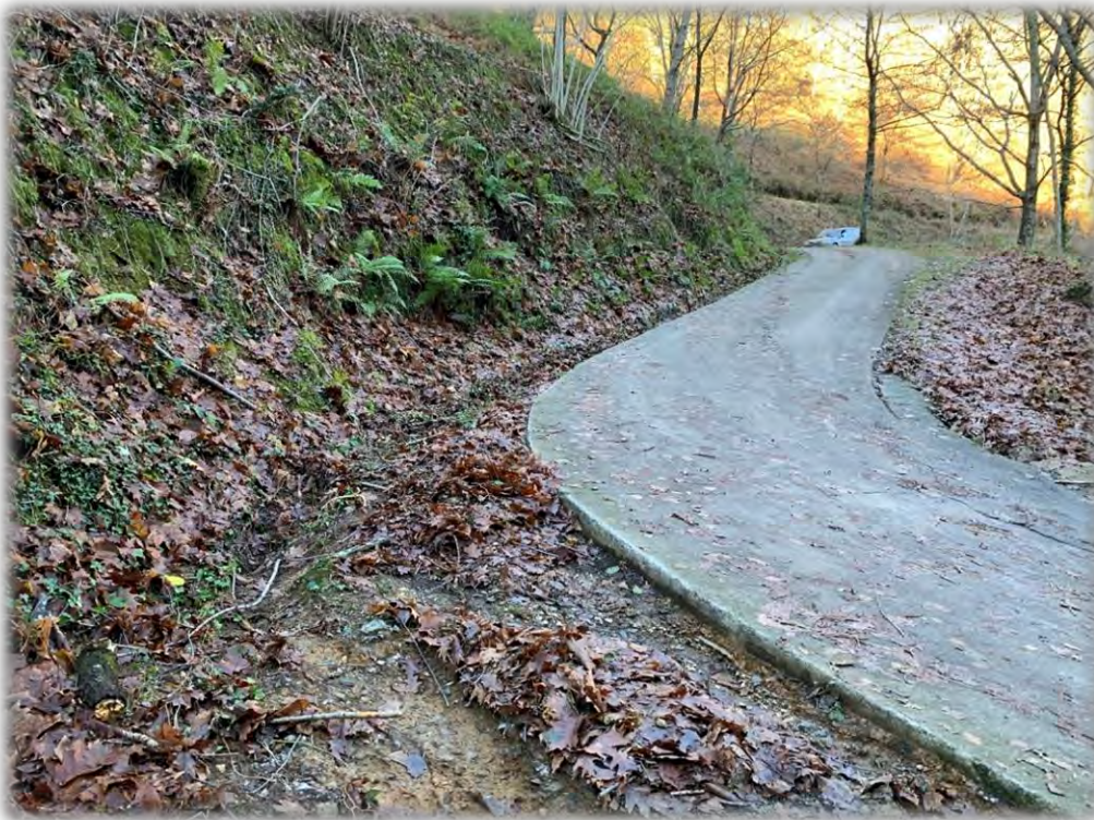
Fotografía 15: Cuenta a reacondicionar ya que el volumen y la fuerza del agua el agua la han dañado.
