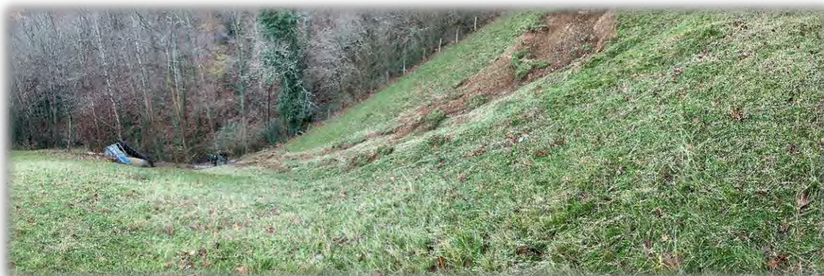
Fotografía 7: Perspectiva del deslizamiento de la ladera. Al fondo se ve el camino.
