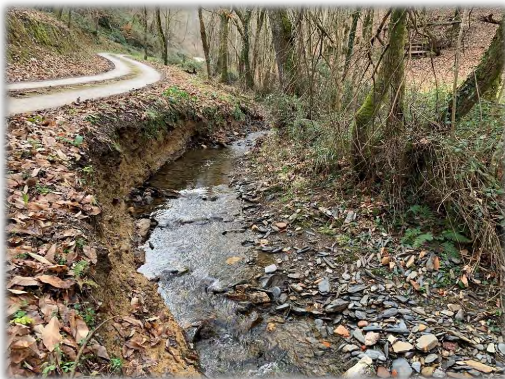
Fotografía 22: Erosión de la margen derecha de la regata y que afecta a la estabilidad del camino.
