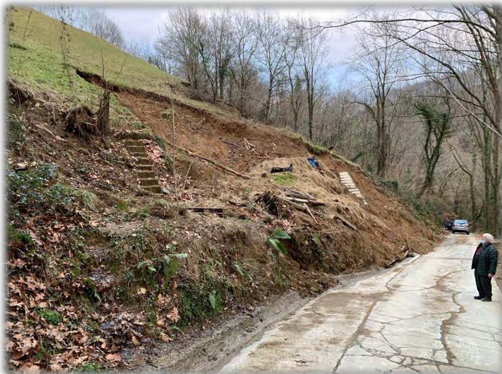
Fotografía 12: Estado del camino tras limpiar parte del deslizamiento, se observa el asentamiento del vial y que el talud lo sigue invadiendo.
