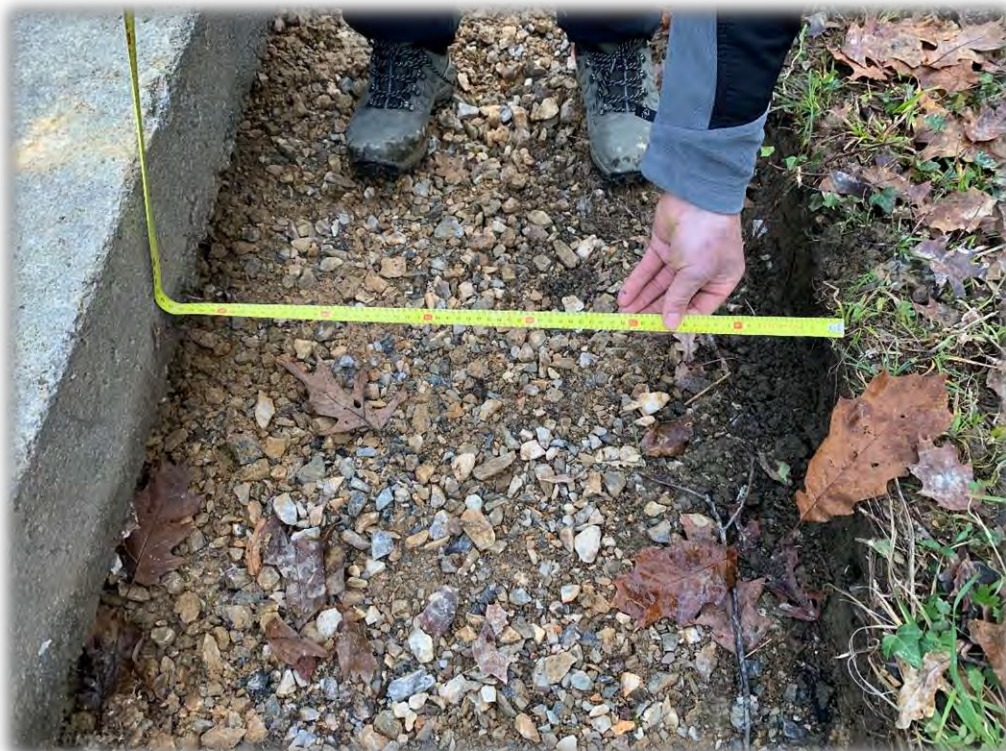
Fotografía 9: Separación creada por el deslizamiento a lo largo de unos 50 m.
