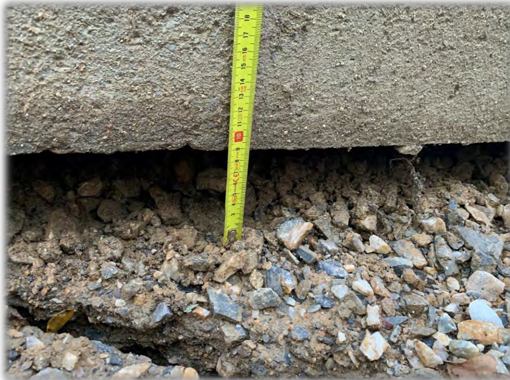
Fotografía 10: Hundimiento del terreno asociado al deslizamiento, dejando descalzado el camino.
