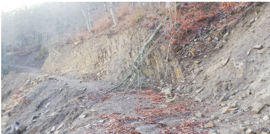
Imagen 3: Desprendimiento de árboles y rocas.-
