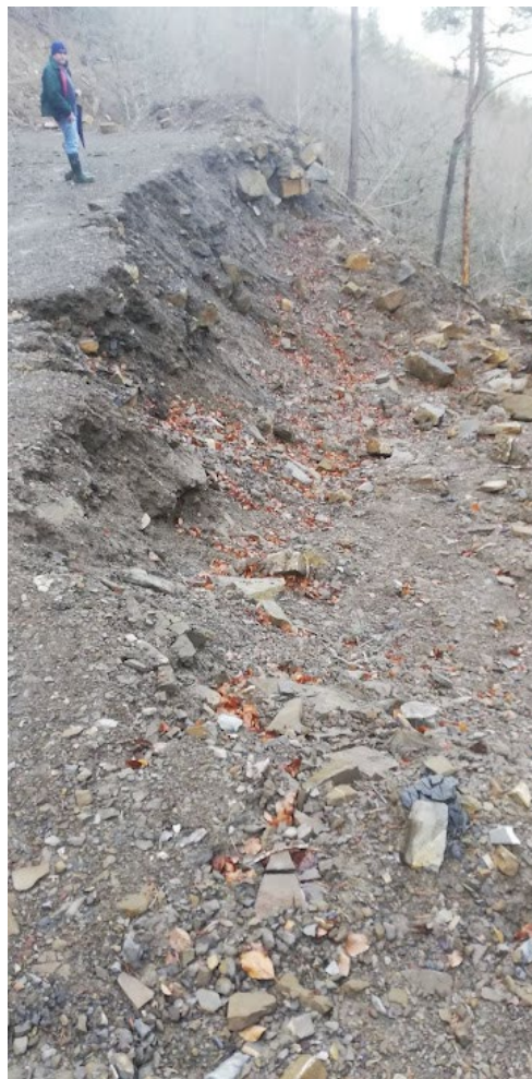
Imágenes 4 y 5: Puntos donde la pista se halla totalmente cortada.-
