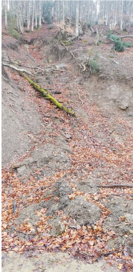
Imagen 2: Deslizamiento de material del talud sobre la explanación.-
