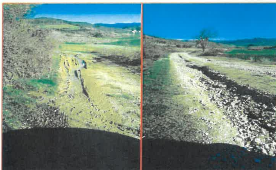
Fotos 3 y 4. Detalle de tramo de Vial 2 tras deslizamiento de talud y colmatación de cunetas (izquierda) y tramo con daños por escorrentías superficiales (dcha).
