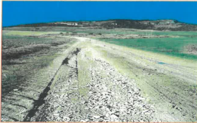
Imagen 2: Detalle de estado actual de tramo de Lizarraga-Potxe susceptible de perfilado, afirmado ZA
