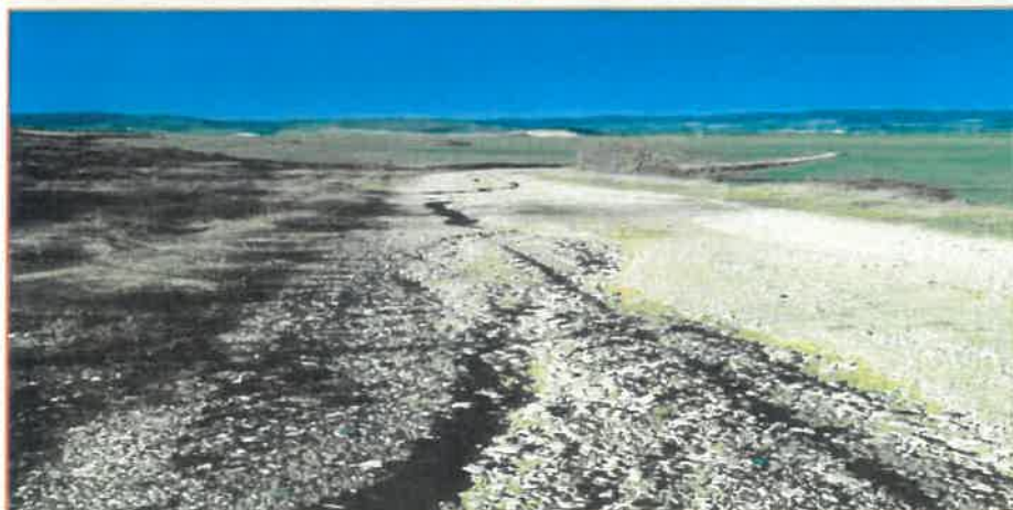
Foto 5. Detalle de tramo de Vial 3 (Camino Reta) con cárcavas producto de la escorrentía laminar superficial por ausencia de elementos de drenaje.
