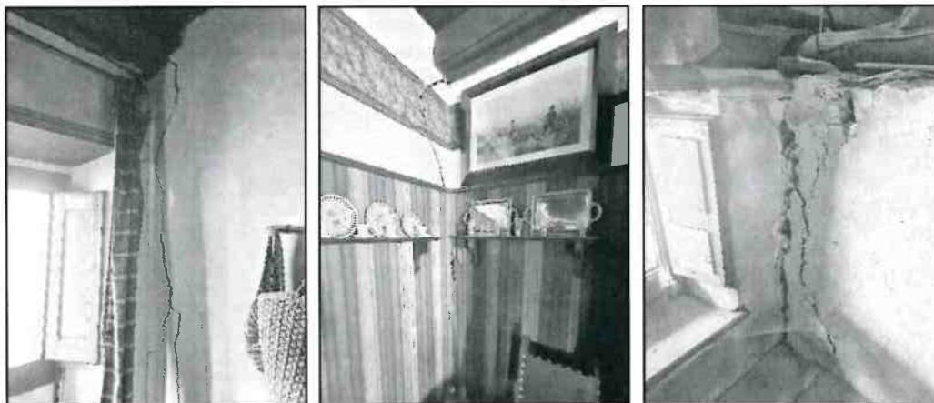
Imagen 3: grietas en fachada norte
