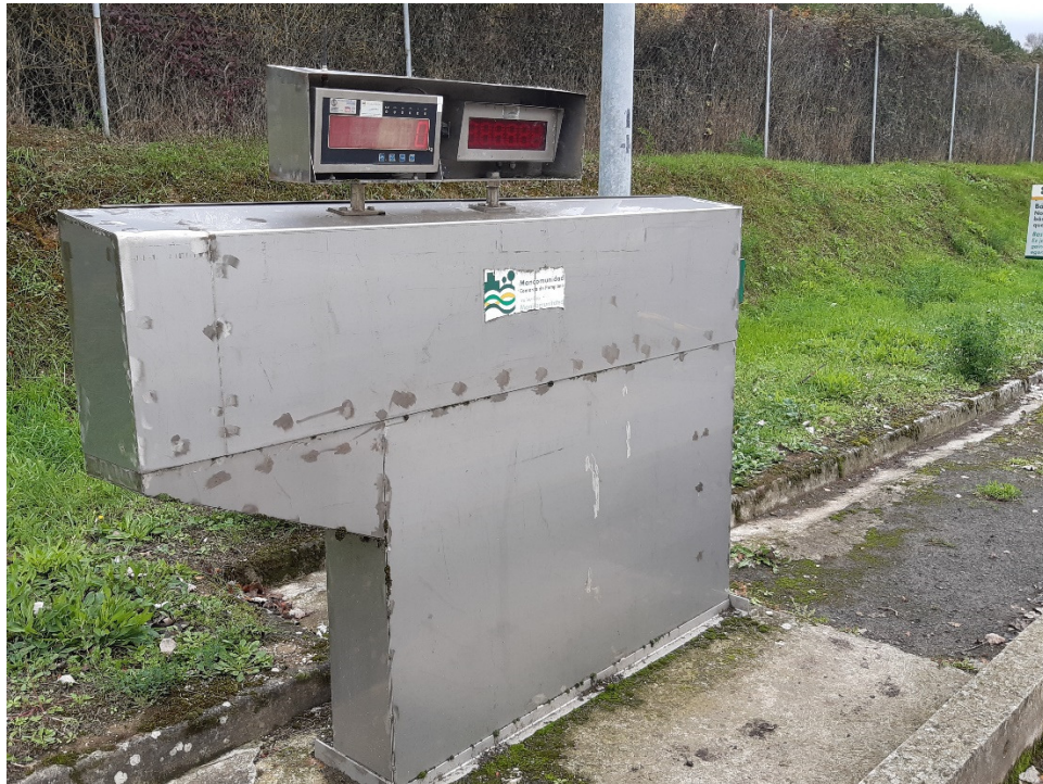
Vista del armario de la báscula Romana y de los repetidores de ambas básculas.
