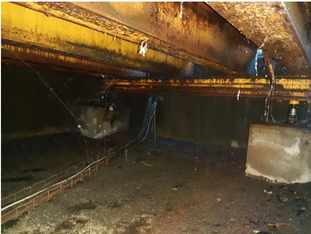
Vista del interior de la segunda báscula con los perfiles metálicos, células de carga, dados de apoyo y canalización de cables a conducir mediante tubo.
