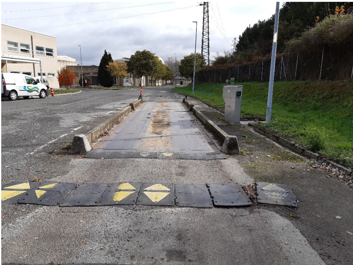
Vista de las dos básculas empotradas. A la derecha el armario de la báscula Romana con los repetidores y el pulsador de emergencia.
