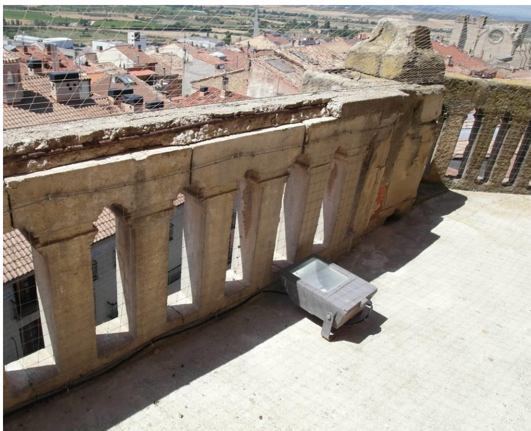
Balaustrada del lado meridional de cemento fundido, con el remate de hormigón reventado. Fuente: IPV
