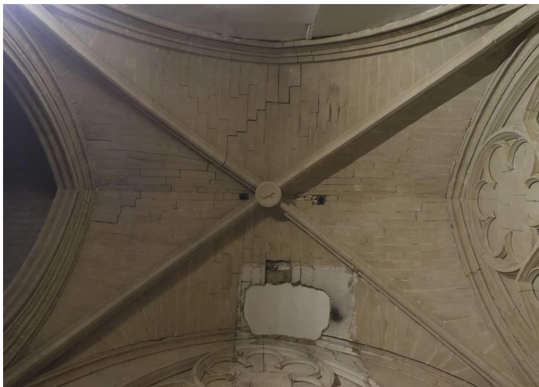
Apertura de juntas en la plementería de la bóveda de la torre en el nivel del coro. Fuente: IPV
