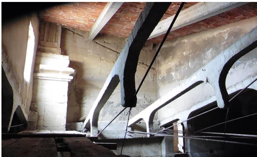
Fotografías que muestran la poca delicadeza con la que atacan al muro septentrional de la torre los faldones de la cubierta de la nave central de la iglesia ejecutada en los años 60 del siglo pasado. Fuente: IPV
