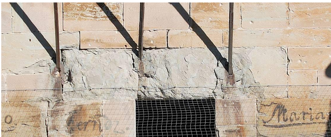
Arriba, erosión en sillares bajo el alféizar del ventanal. Abajo, erosión del dintel en el que están anclados los jabalcones de las rejas. Fuente: IPV
