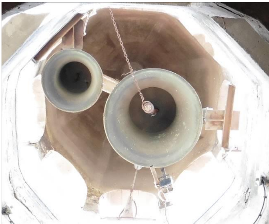
Campanas del chapitel. Fuente: IPV
