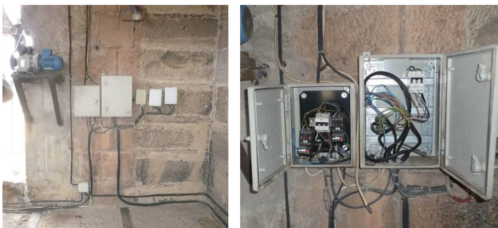
Cuadros de protección y cajas de empalme en el muro oriental del cuerpo de campanas. Fuente: IPV
