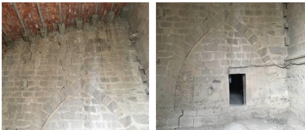
Muro oriental de la torre al nivel de la cámara visto desde la bajocubierta, detalle de las grietas. Fuente: IPV
