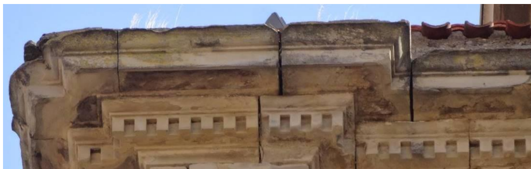
Detalle de la cornisa en el que todavía se puede distinguir el goterón. Fuente: IPV
