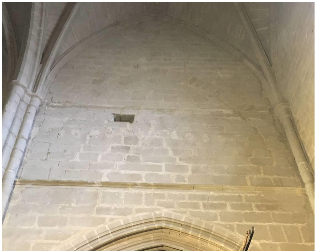
Vista del muro norte de la torre desde el coro en la que se distinguen los arcos de descarga y las fisuras existentes. Fuente: IPV
