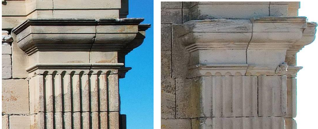
Capiteles de las pilastras. Tal y como muestra la fotografía de la izquierda, correspondiente al capitel derecho de la fachada oriental, en general los capiteles se encuentran bastante buen estado de conservación. A la izquierda, detalle del capitel derecho de la fachada, el peor conservado. Fuente: IPV
