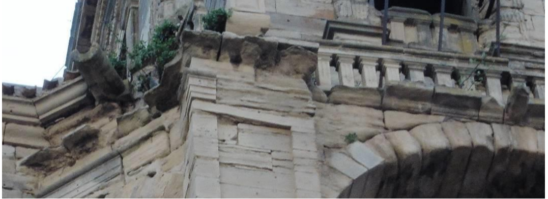
Detalles de la cornisa que muestran el grado de deterioro
