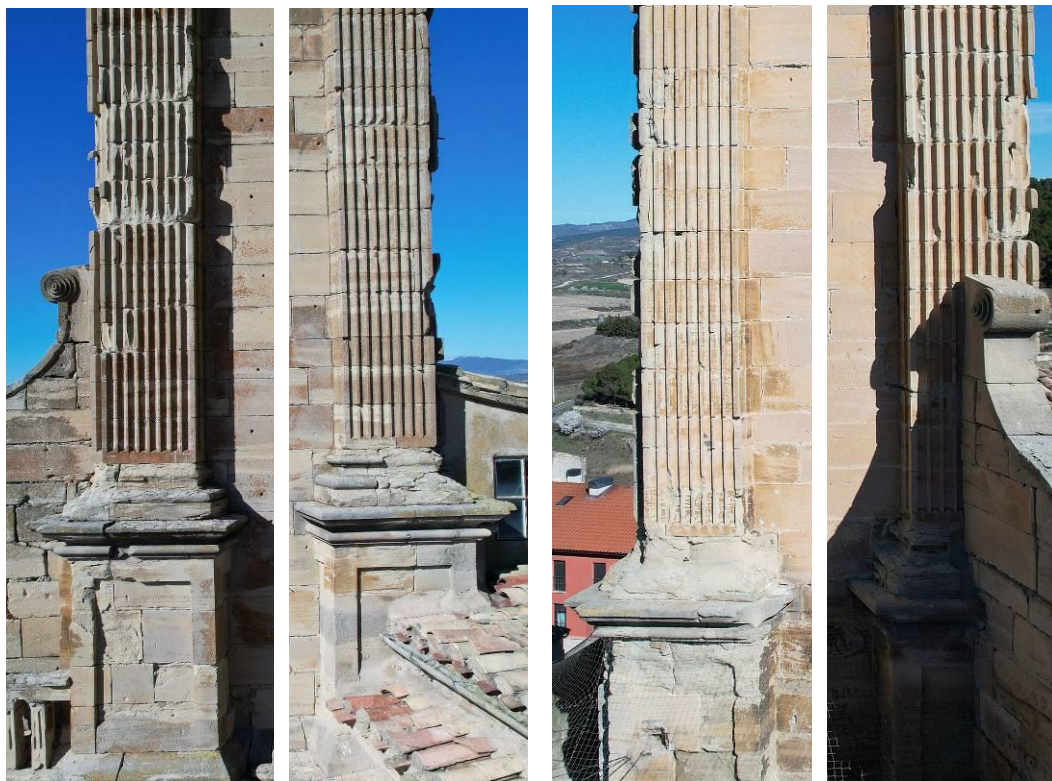
Detalles de la parte inferior de las pilastras de la fachada este (izquierda) y de la sur (derecha). Fuente: IPV
