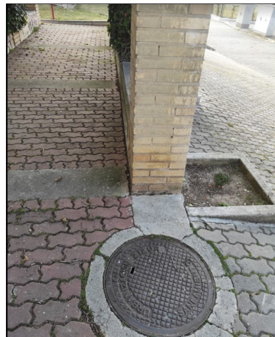
FOTO 14: Pozo de saneamiento red de HM400
