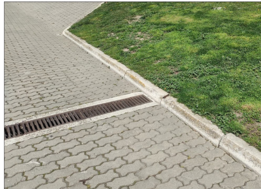
FOTO 5: Canaleta pluviales con posible salida a desviar
