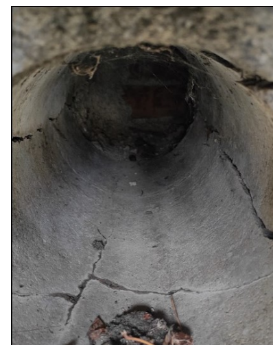
FOTO 8: Salida interior de la canaleta-2
