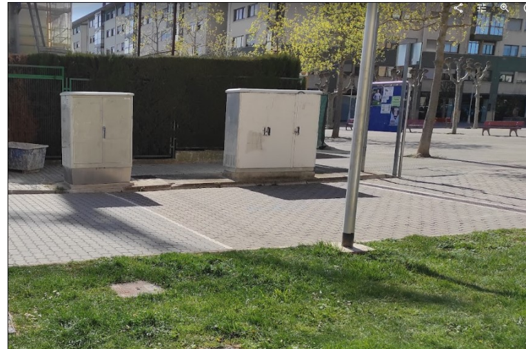
FOTO 11: Armarios de telecomunicaciones frente al baño autolimpiable
