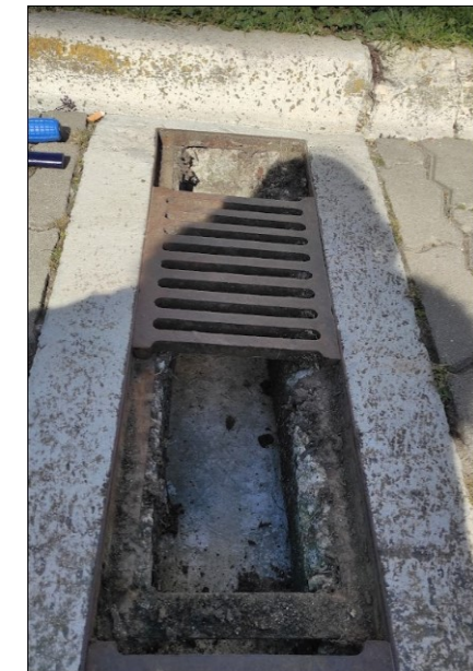
FOTO 6: Interior de canaleta Paseo Kirolaldea
