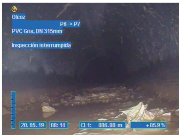
Fotografía: 6b 6,8m, Inspección interrumpida
