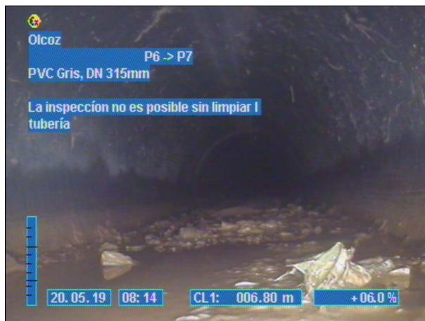
Fotografía: 5b 6,8m, La inspección no es posible sin limpiar l tubería
