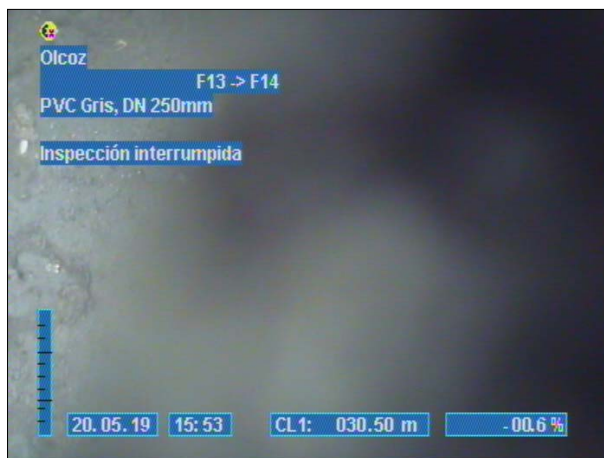
Fotografía: 203b 30,5m, Inspección interrumpida
