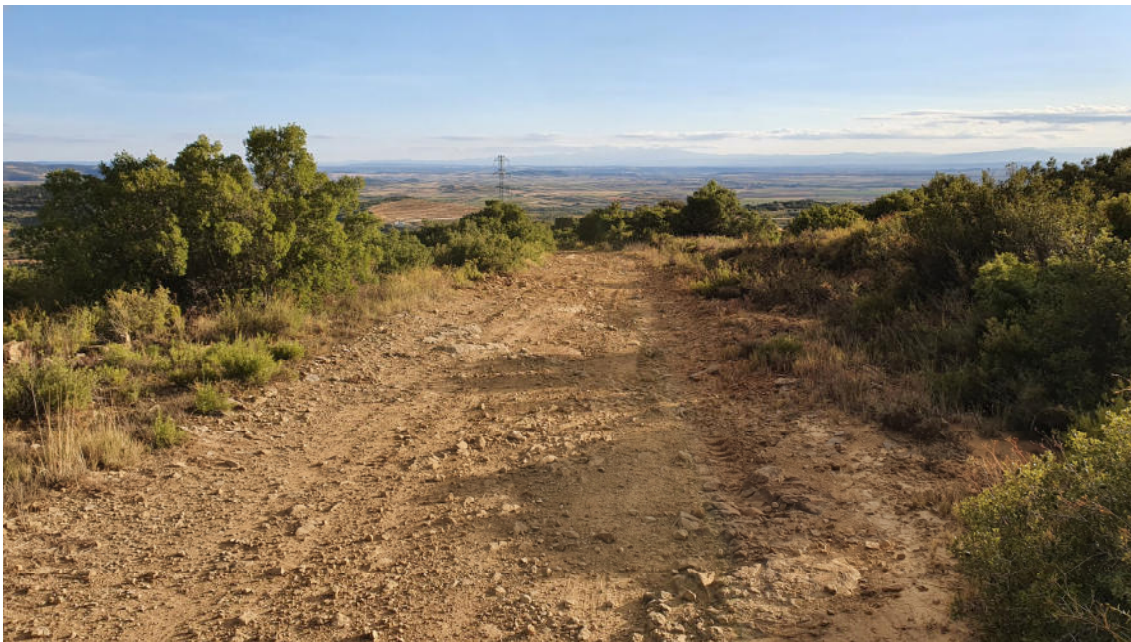
Fotografía del estado actual de las cunetas en la pista forestal principal del Camino Corral del Alto-La Revuelta de Valero
