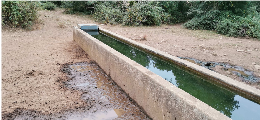
Ilustración 4. Abrevadero a arreglar
