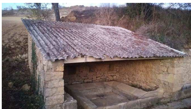
Ilustración 4: Lavadero de Arzoz con cubierta de uralita a sustituir
