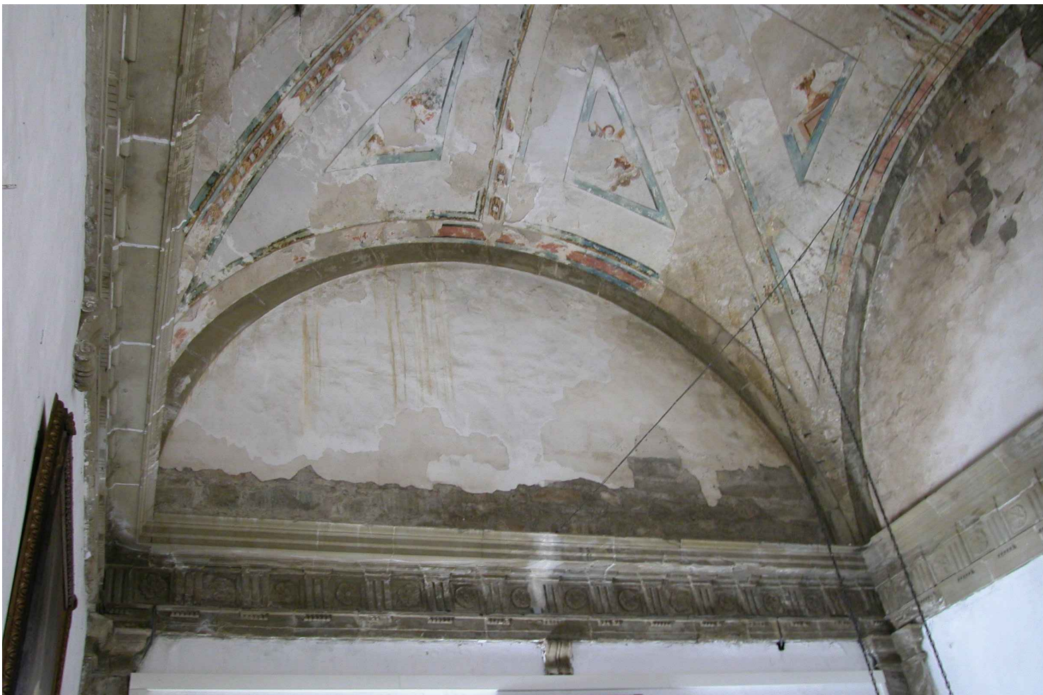
5. Daños en el revestimiento policromado de la bóveda y del paramento de la sacristía nueva
