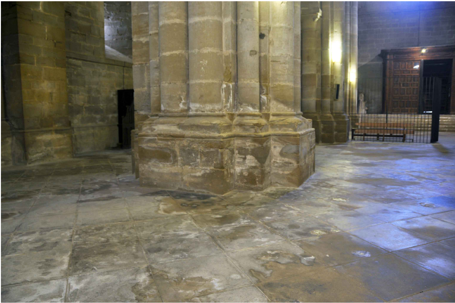
1. Eflorescencias salinas y manchas de humedad en pilares y pavimento de las naves
