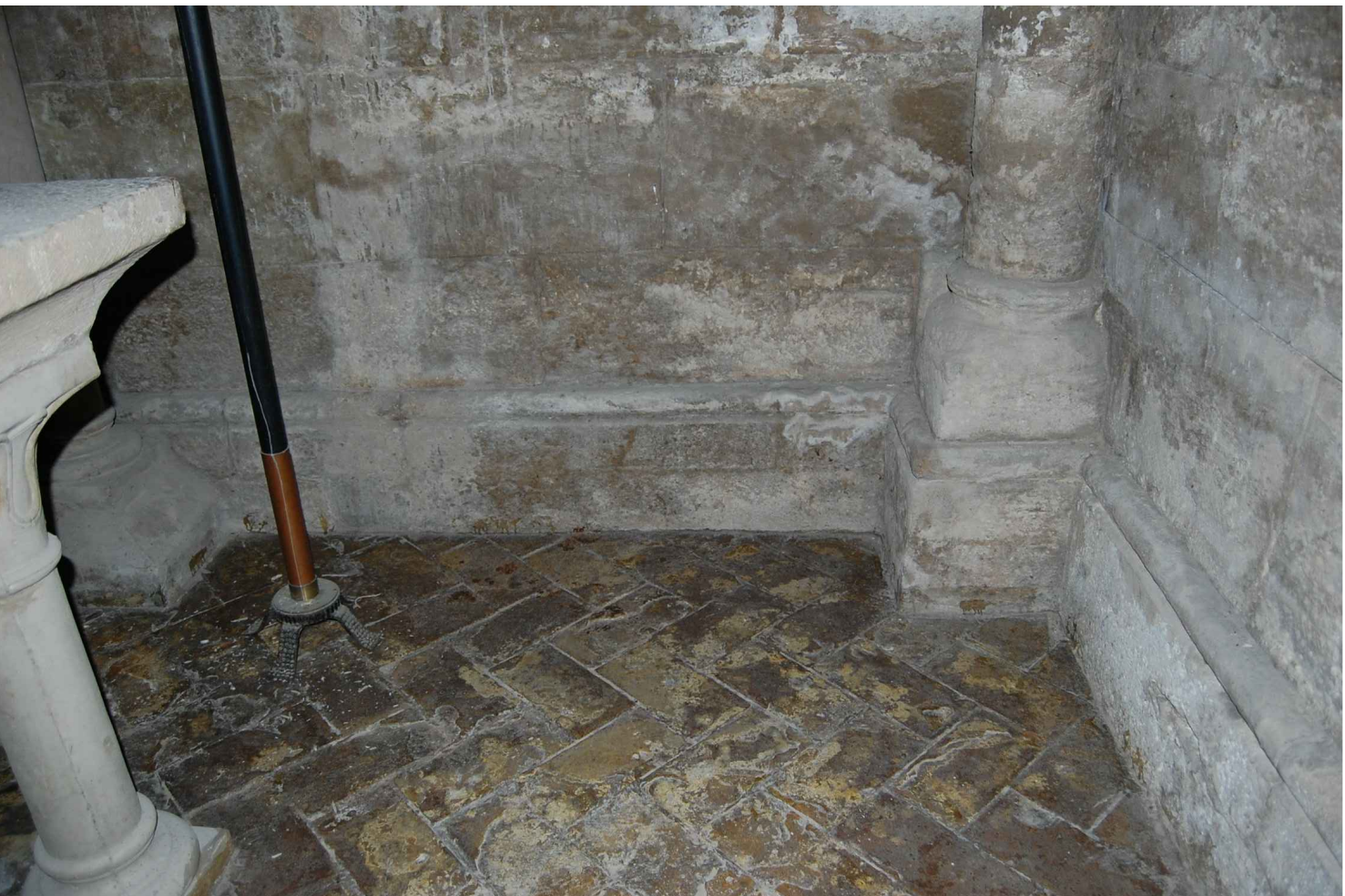
6. Pavimento degradado y paramentos con sales por capilaridad en la capilla de San Benito
