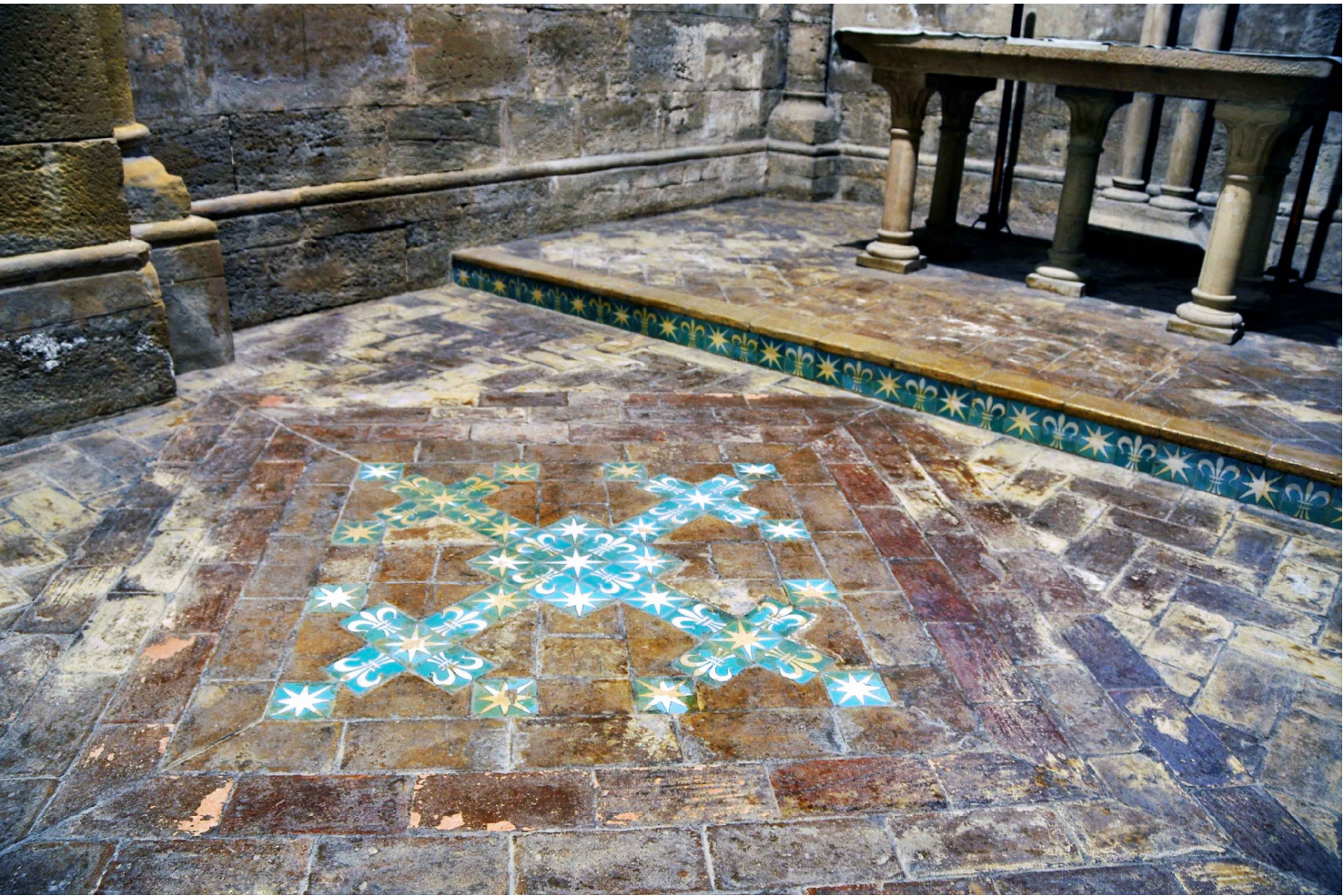
2. Roturas y sales en el pavimento cerámico de la capilla de San Bernardo
