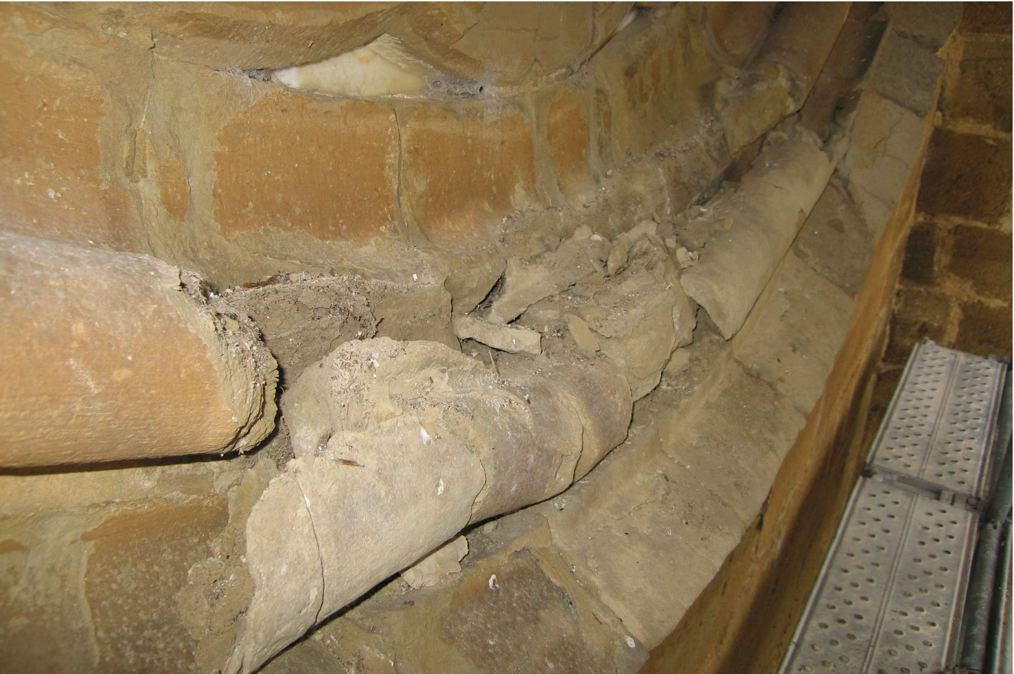
15. Baquetón roto en el rosetón gótico de la nave lateral norte
