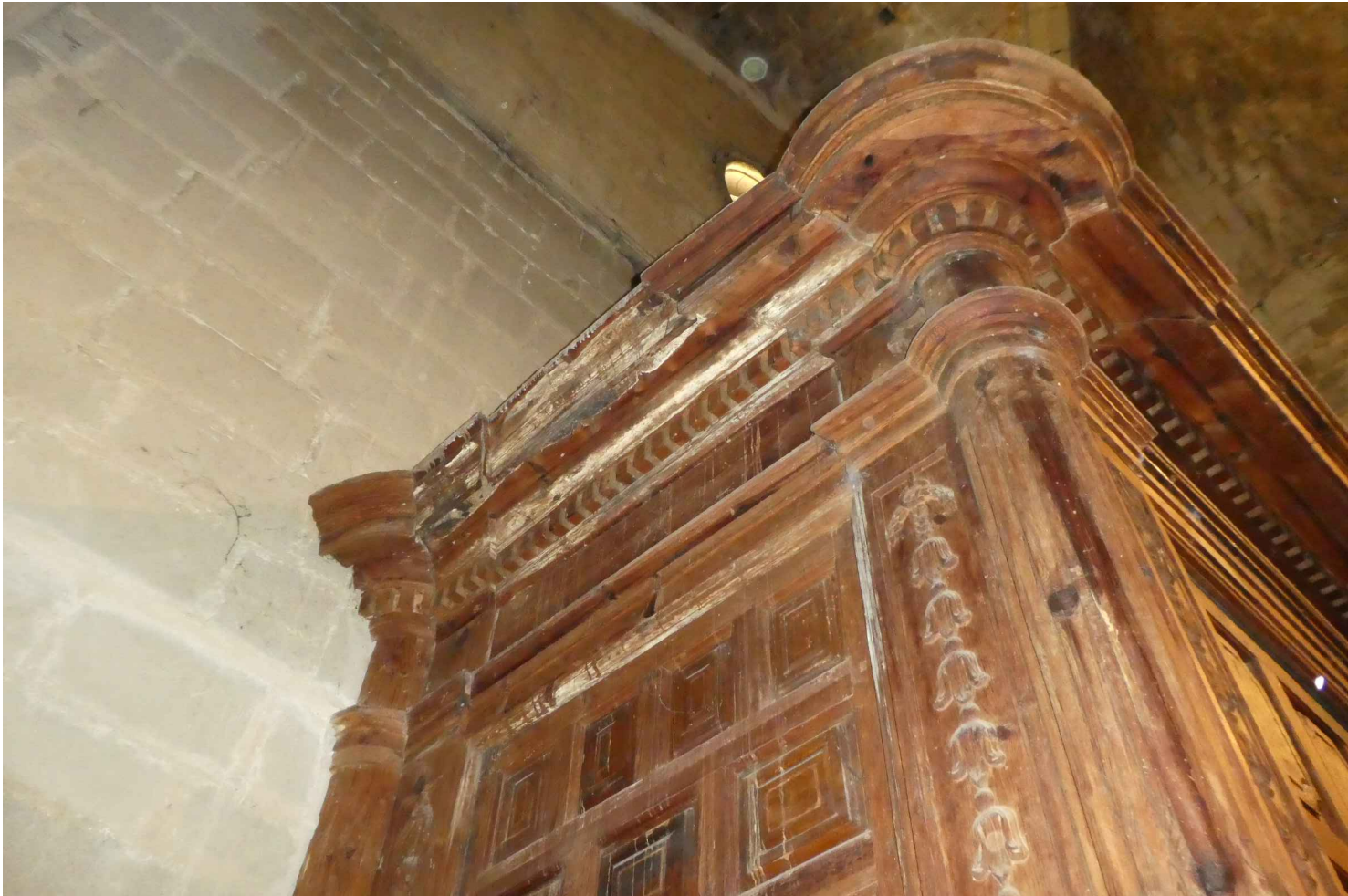
16. Cornisa de madera dañada en cancela de puerta de acceso
