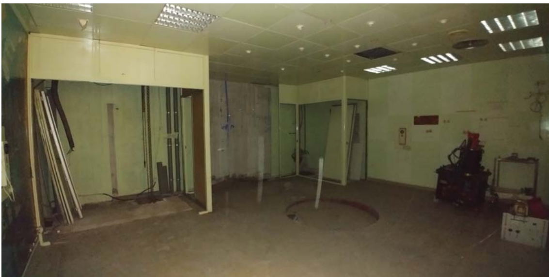
Sala antiguo Acelerador. Espacio previsto para ubicación del PET-CT.
