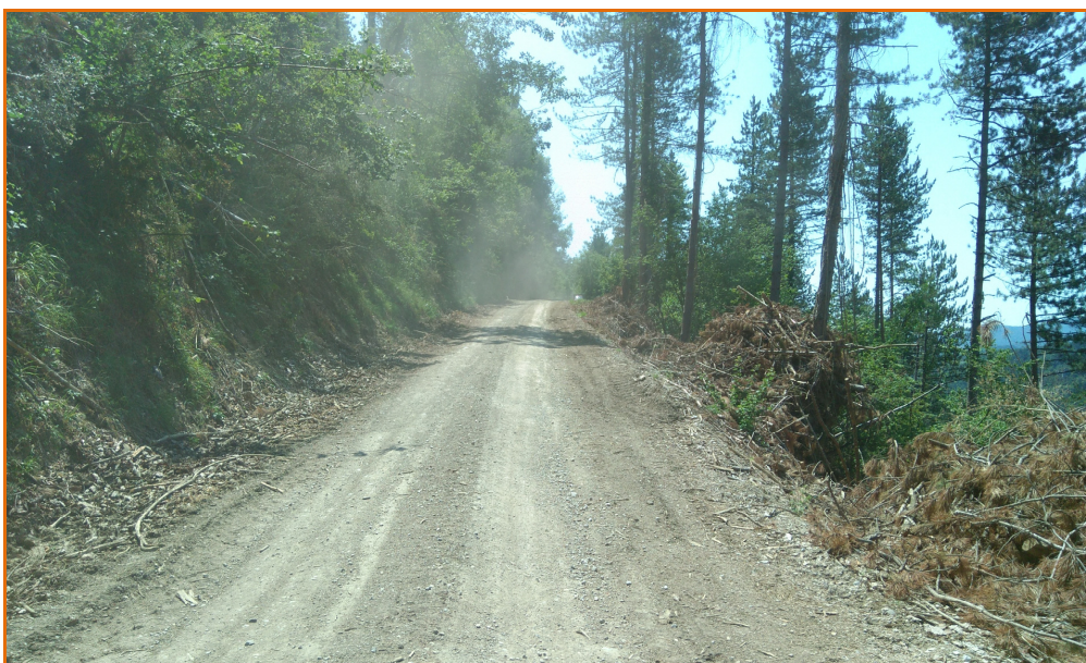
Foto 2. Diversos detalles del estado actual de la explanación y ausencia de firmes en pista La Sarria tras la explotación forestal de 2021.
