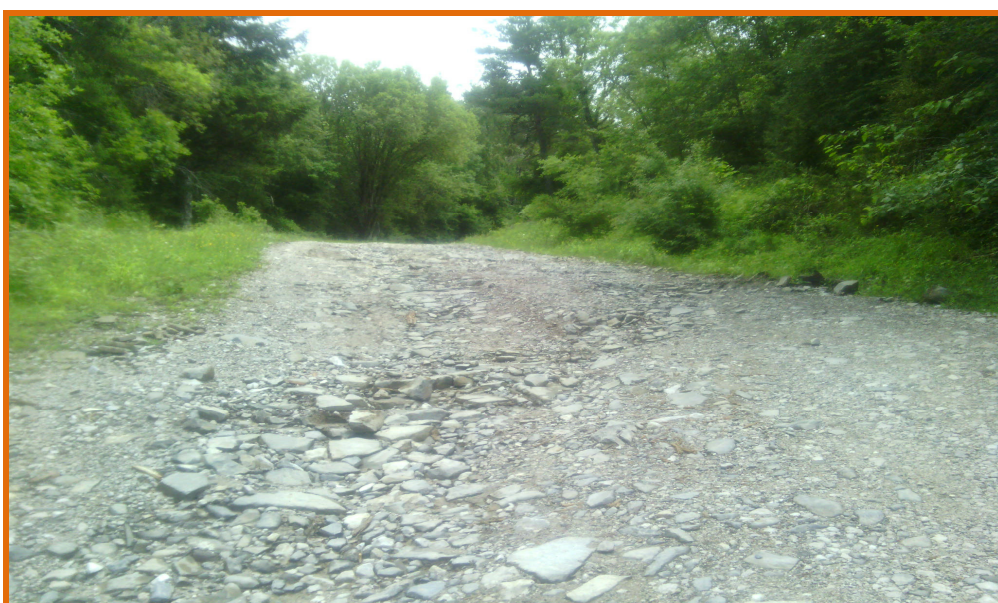
Foto 3. Diversos detalles del estado actual de la explanación y ausencia de firmes en pista La Sarria.
