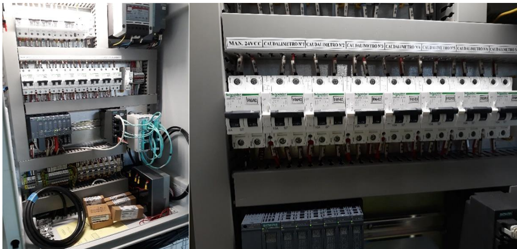
Foto cuadro eléctrico actual
