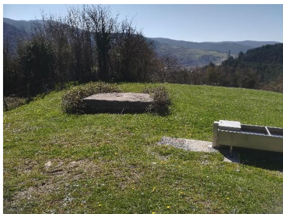
Nudo tubería 100 FN y abrevadero
