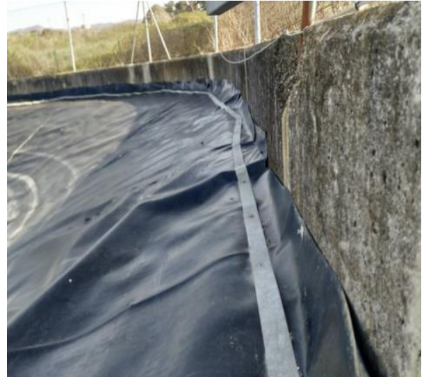
Fotografía 5. Pletina perimetral defectuosa.
