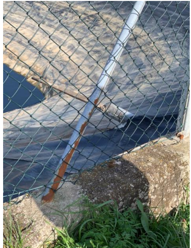
Fotografía 9. Entrada de lixiviado con "bota" de tela asfáltica.
