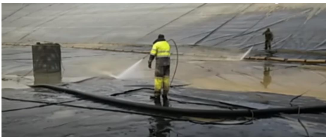
Fotografía 3. Limpieza inadecuada de soldaduras a “contrapelo”.
