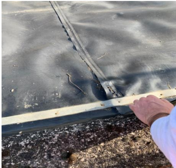
Fotografía 4. Soldadura de termofusión dañada en coronación
