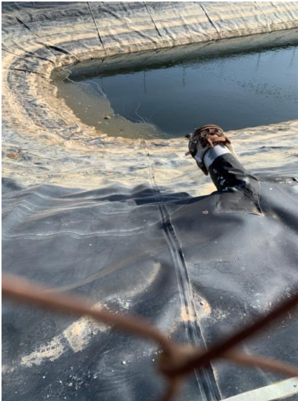
Fotografía 8. Tubería de rebose, con parche de tela asfáltica.
