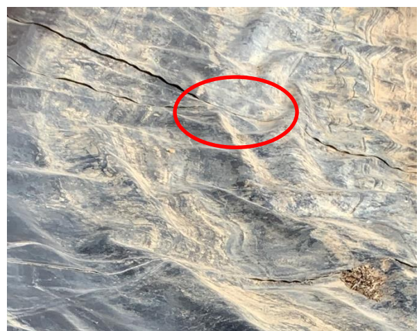
Fotografía 7. Punto triple sin refuerzo.
