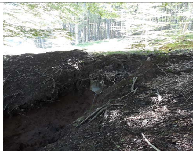
Caño desprendido (tarea puntual 1)
