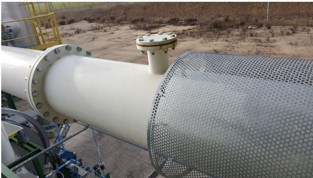
Figura 5. Detalle de la conexión a la tubería del gas de síntesis (brida DN100 PN25)
