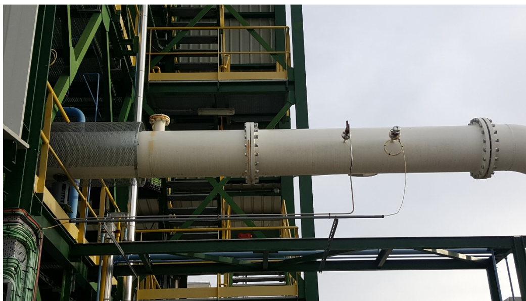
Figura 4. Tubería del gas de síntesis generado en la planta de gasificación
