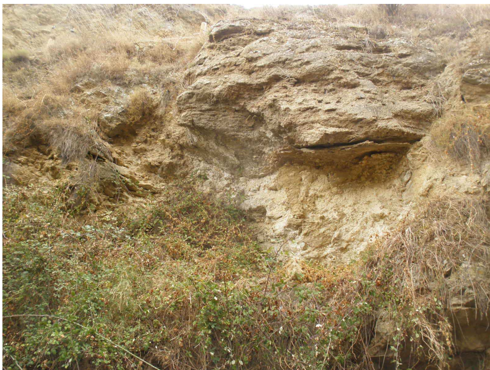
FOTO 11: Vista en detalle de la masa rocosa en voladizo y de la parte inferior rehundida más terrosa y de carácter más meteorizable. Obsérvese en la base del saliente la delgada capa de yeso despegada.
