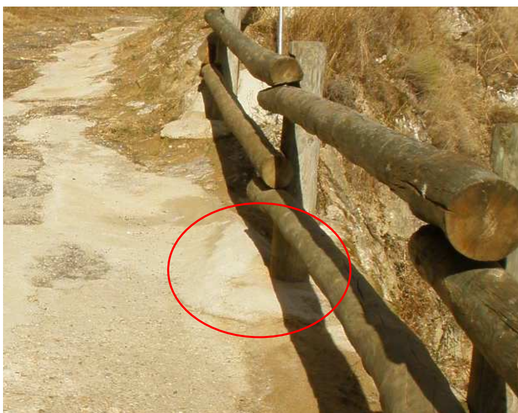
FOTOS 8 y 9: En las fotografías se señala con un círculo rojo la zona parcheada con hormigón para tapar una pequeña grieta. No se observan alteraciones en el parcheado.
