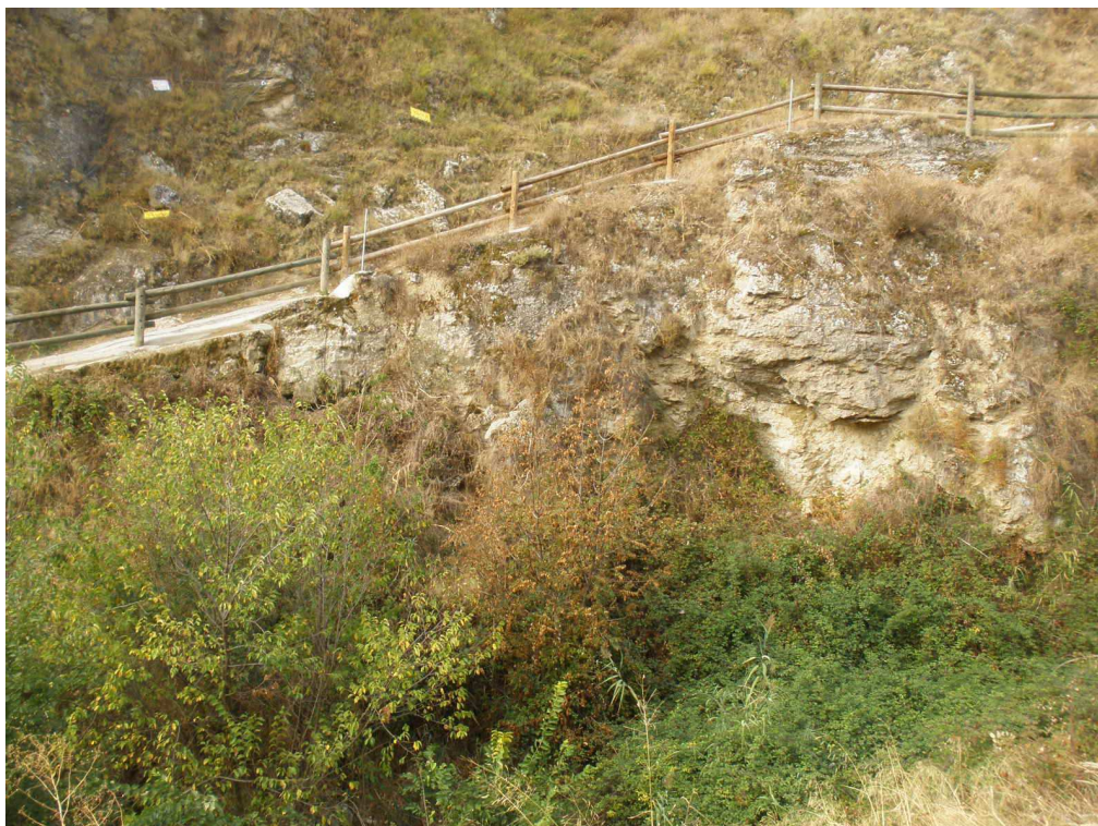
FOTO 3: Vista general de la parte alta del tramo de trabajo. Obsérvese la presencia de una importante masa de roca de yeso que vuela sobre el paramento inferior del talud.
