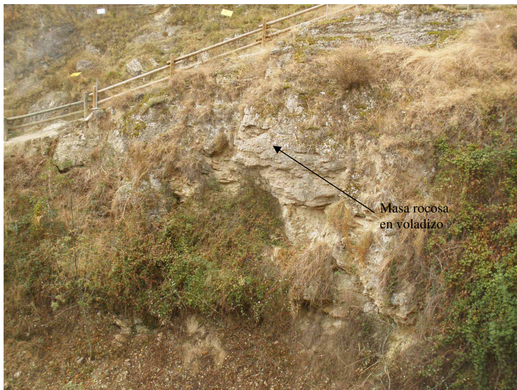
FOTO 10: Vista general del primer tramo del talud próximo a la cascada. En la fotografía se señala la localización de una masa rocosa de yeso en voladizo.
