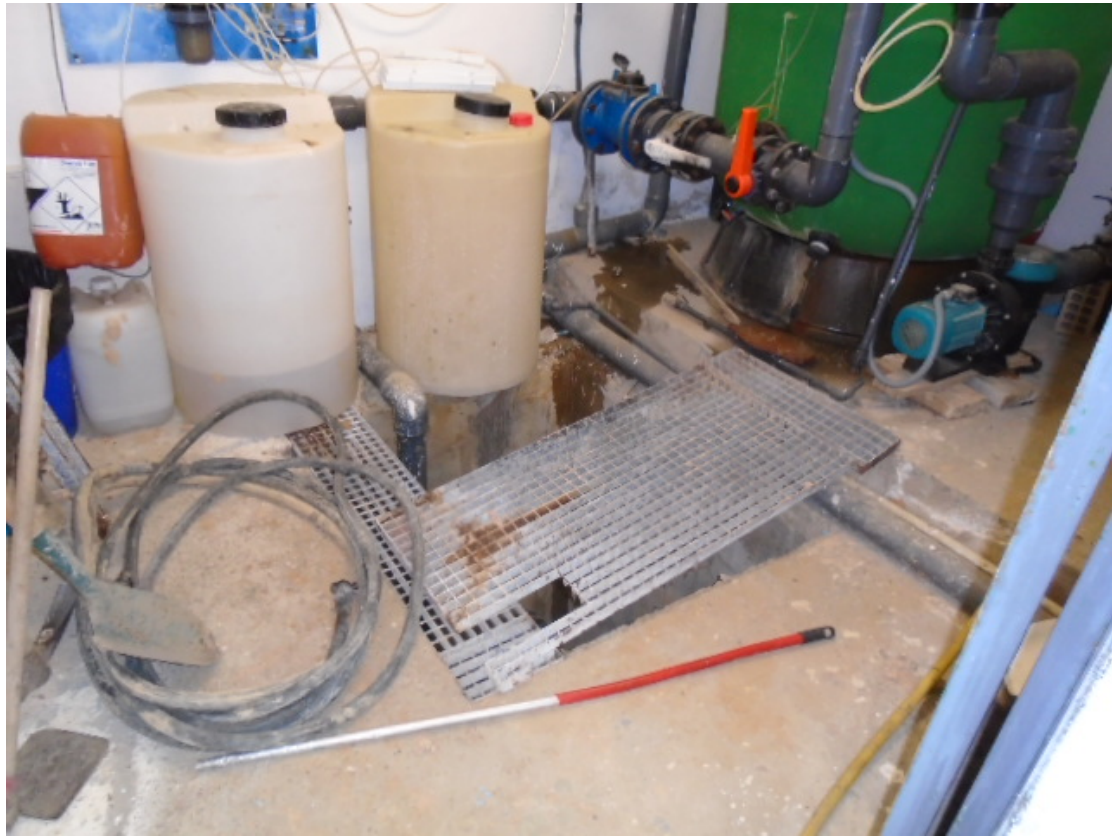
INSTALACIONES DE TRATAMIENTO DE AGUA
