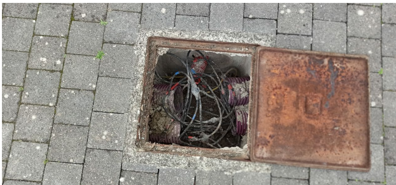
FOTO 13: Vista arqueta eléctrica.
