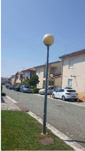
Luminaria “parque” en columna a 3 m.
