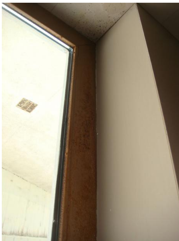
Estado interior de las carpinterías de acero corten
