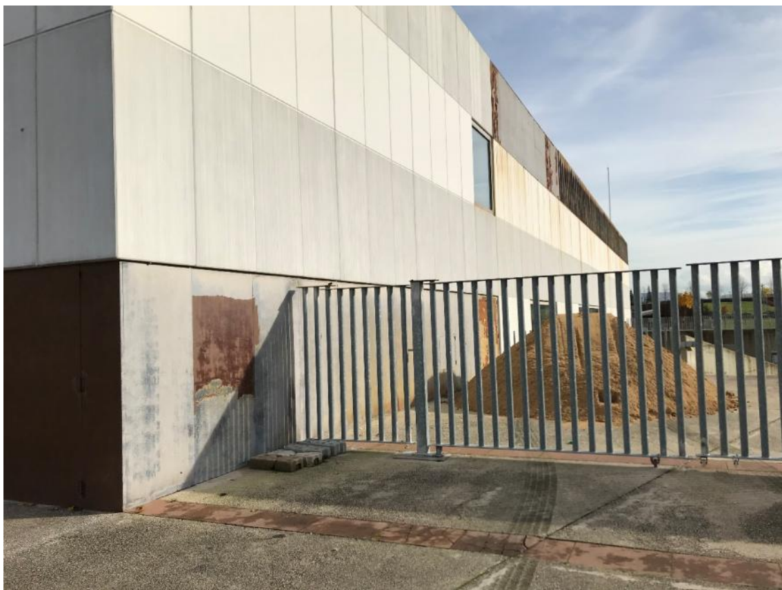
Fachada Suroeste afectada
