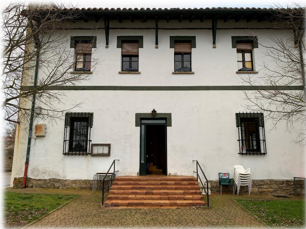
Fotografía 7 – Exterior, fachada principal, de la casa concejil, en la que se observan las grietas a reparar.
