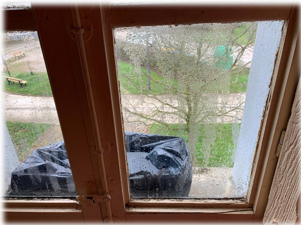
Fotografía 5 –Tipo de las ventanas de madera con cristal simple que hay en la primera planta y que se contemplan renovar. Se observa condensación.
