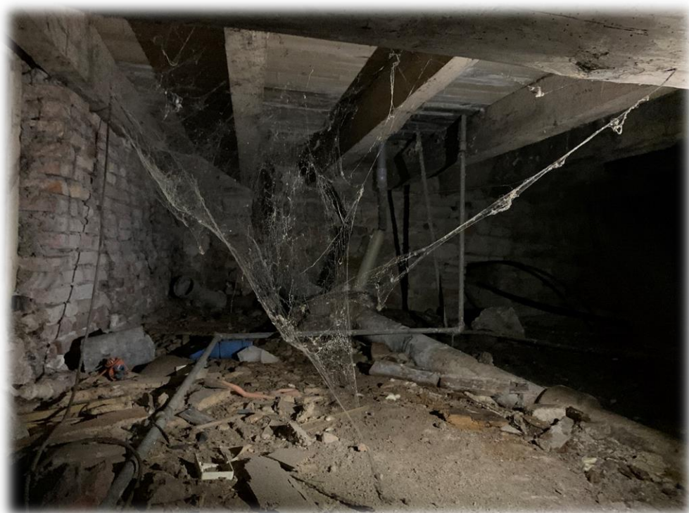
Fotografía 1 – Entre suelo, se observa la tubería de saneamiento de fibrocemento y vigas apolilladas.
