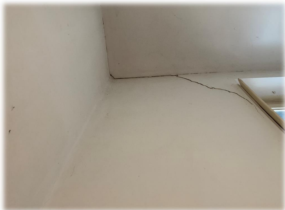
Fotografía 6 –Grieta en el interior del edificio a reparar.
