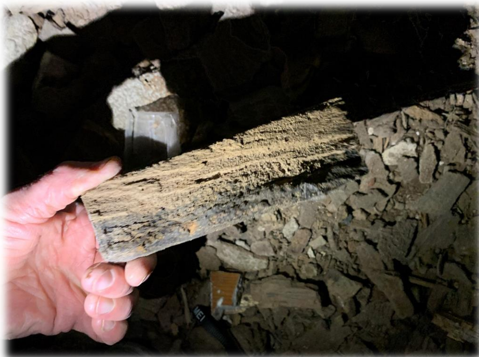
Fotografía 2 – Trozo del forjado del entresuelo de la planta baja desprendido por la acción de los xilófagos, que demuestra la necesidad de renovación.
