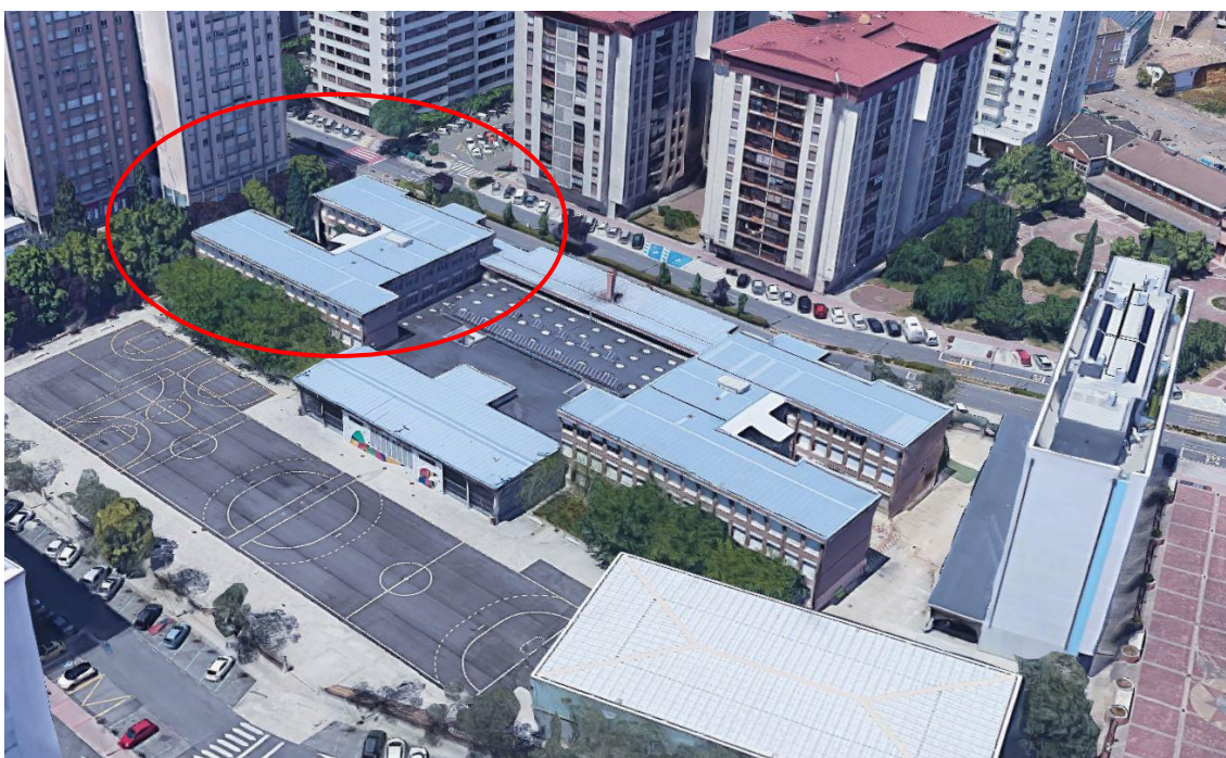
Parte de la cubierta que presenta los problemas de filtraciones.
