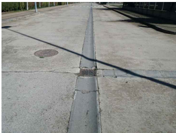
F3 CAZ FISURADO Y SUELTO, ASENTAMIENTOS GRIETAS PAVIMENTO DE CALZADA
