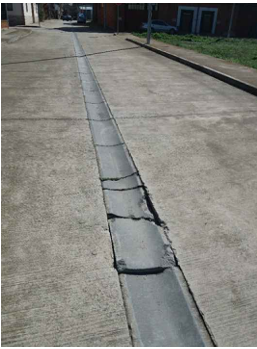
F5 CAZ FISURADO Y SUELTO
