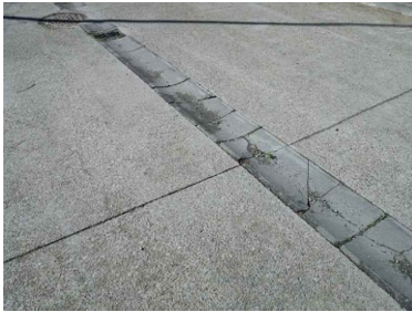
F4 CAZ FISURADO Y SUELTO, ASENTAMIENTOS
