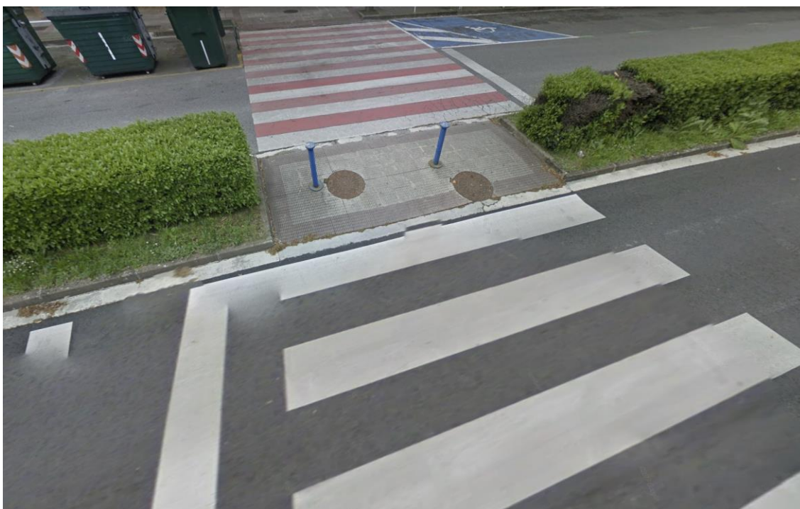
FOTOGRAFÍA 12. PASO PEATONES AVDA. EULZA
