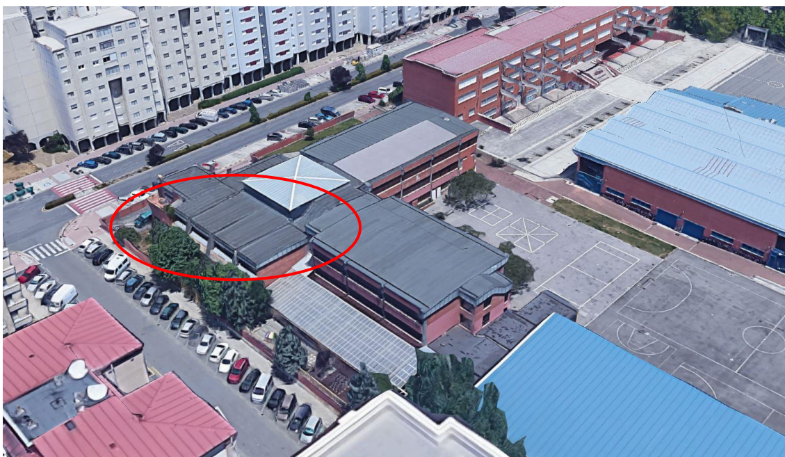
Parte de la cubierta que presenta los problemas de filtraciones.
